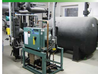
Kälteanlage in Bad Elster
