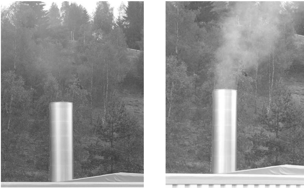
Bild 4.4: Nebelschwaden mit (links) und ohne (rechts) Filteranlagen
