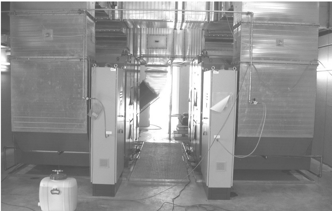
Bild 2.1: Gesamtanlage der elektrostatischen Luftfilter
