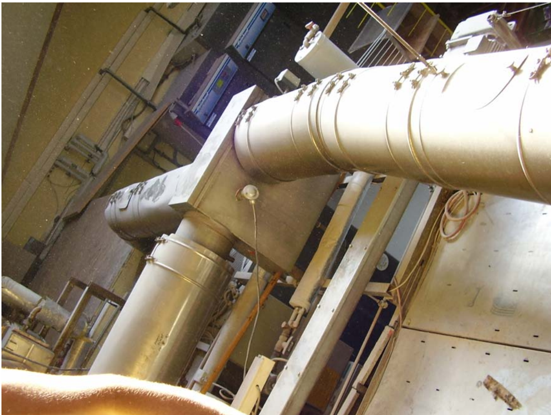
Abb. 17 Schwadenabzüge mit Schwadenkondensator (Kasten)
