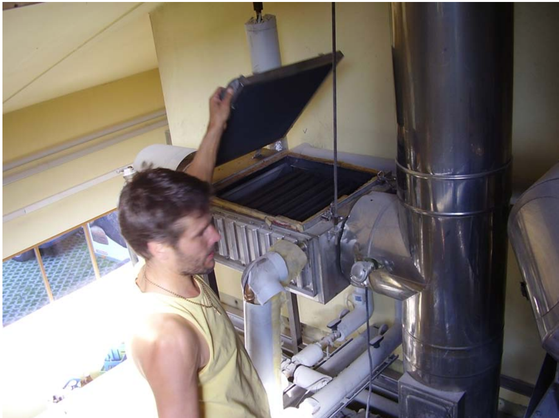
Abb. 15 Abgaswärmetauscher des Etagenofens mit geöffneter Abdeckung
