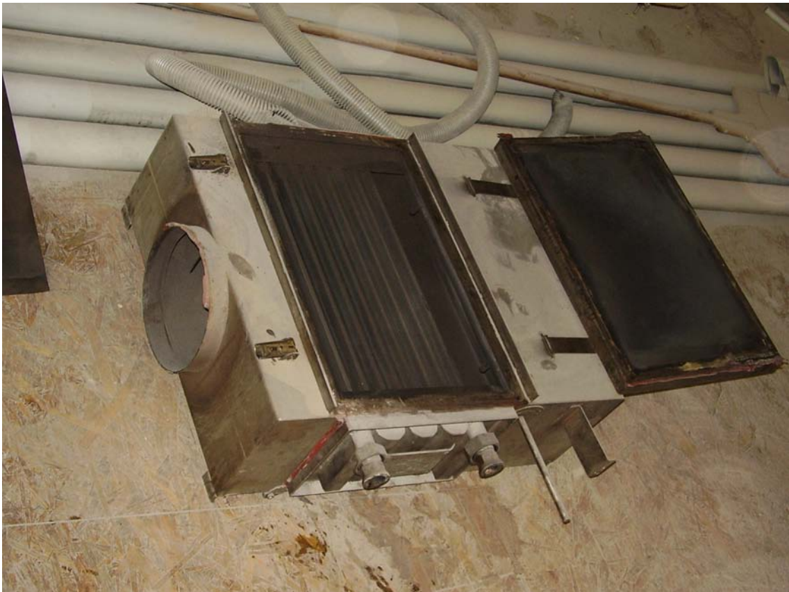
Abb. 16 Ausgebauter Abgaswärmetauscher mit sichtbarem Glattrohrregister
