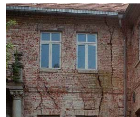
Gebäuderisse in Folge von Setzungen
