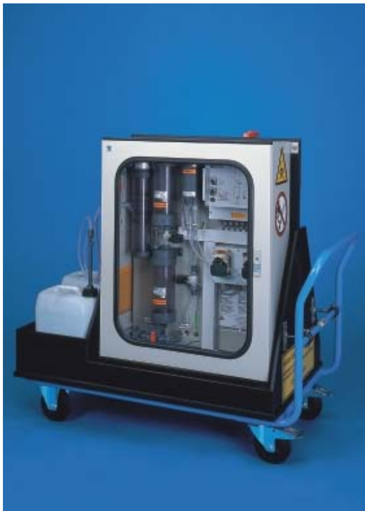
Abbildung 26: Mobile Chlordioxid-Bereitungs- und Dosieranlage. Dieser Anlagentyp wird zur Legionellen-Bekämpfung in Warmwassersystemen eingesetzt.
