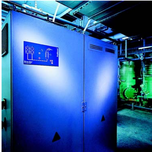
Abb.: 1: Ozonerzeugungsanlage aus Basis Luftsauerstoff
