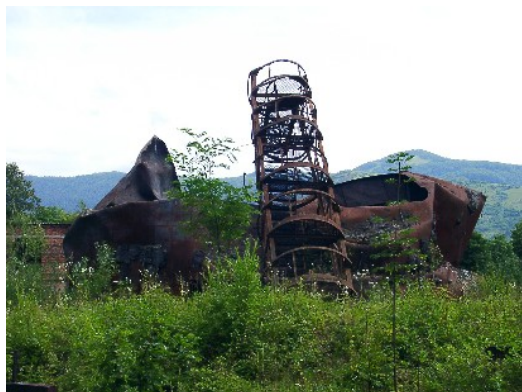
Фотография 4: Разрушенная мазутная ёмкость в непосредственной близости от Тисы
