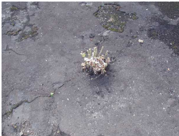
Фотография 20: Повреждения уплотнительной поверхности, вызванные растениями
