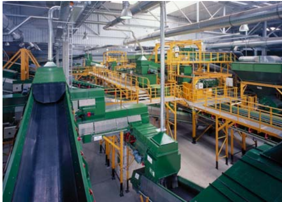
Mechanische Aufbereitung einer MBA-Anlage Quelle: Linde-KCA-Dresden GmbH
