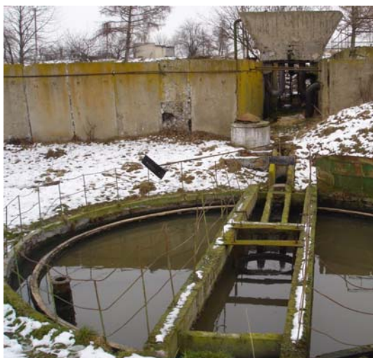
Коммунальные очистные сооружения в г. Золочив (Украина) Фото: Дреберис ГмБХ, Дрезден
