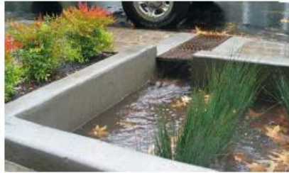
Abb. 27 Zuleitung wenig belasteter Straßenabflüsse in ein Tiefbett
