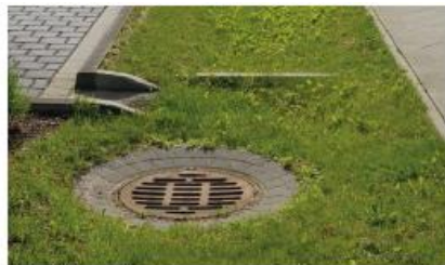
Abb. 24 Dezentrale Straßenentwässerung über Muldenkaskaden
