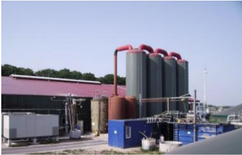
Abbildung 87: Benas GNS FiberPlus Anlage in der Nähe von Bremen
