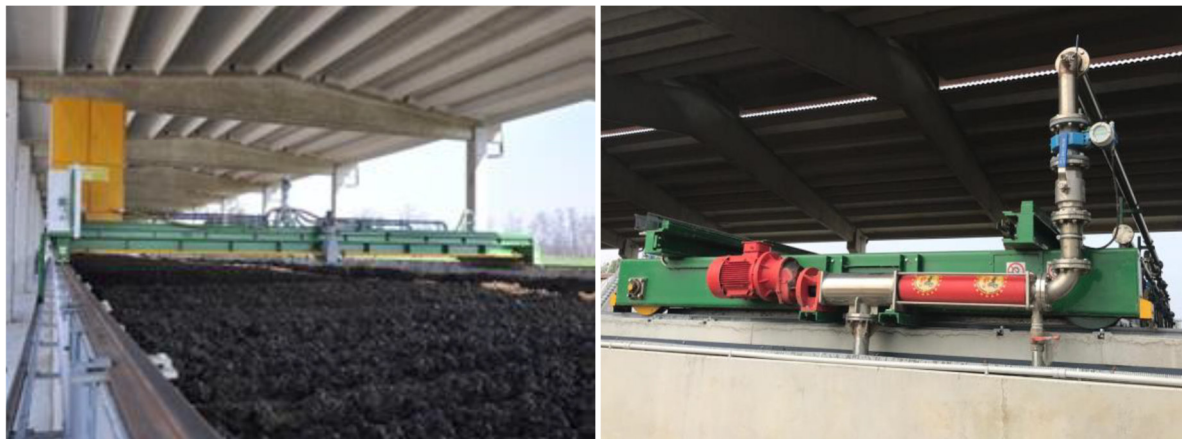
Abbildung 24: Beispiel einer Kompostierungsanlage mit Laufkran und Dosierpumpe
