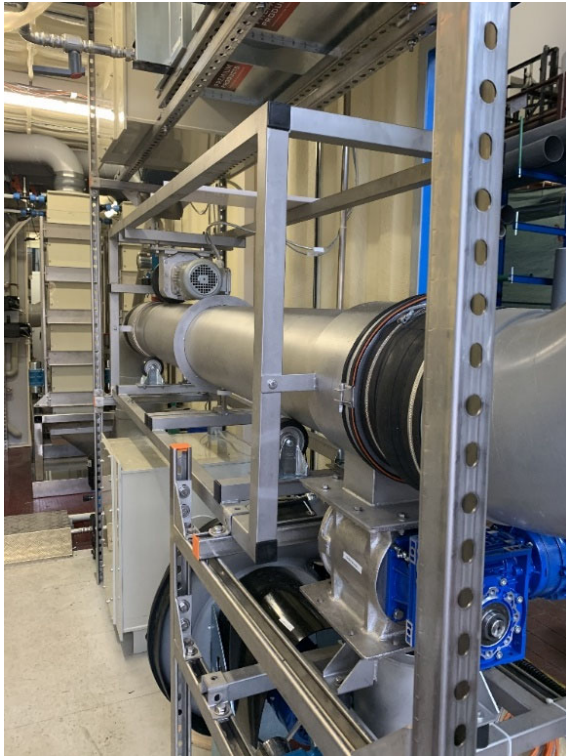
Abbildung 74: Kristallisator mit anschließender Trocknung
