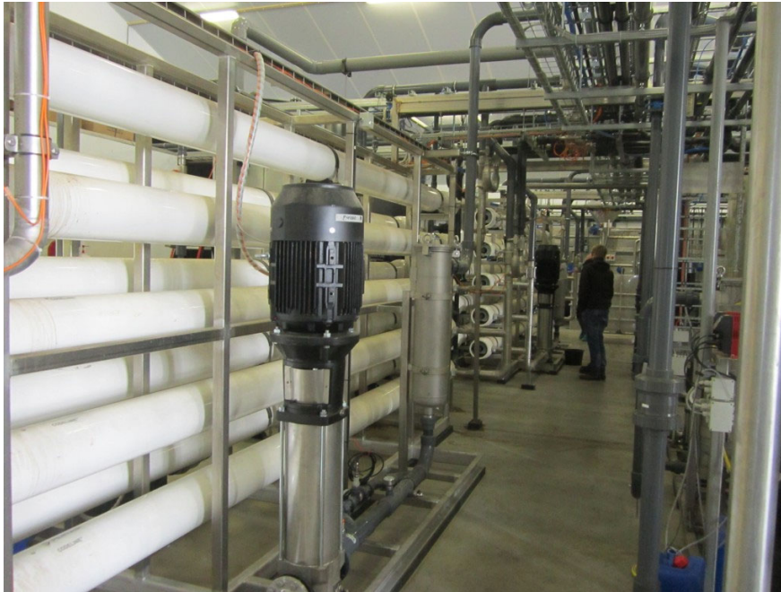
Abbildung 52: Beispiel einer Umkehrosmoseanlage
