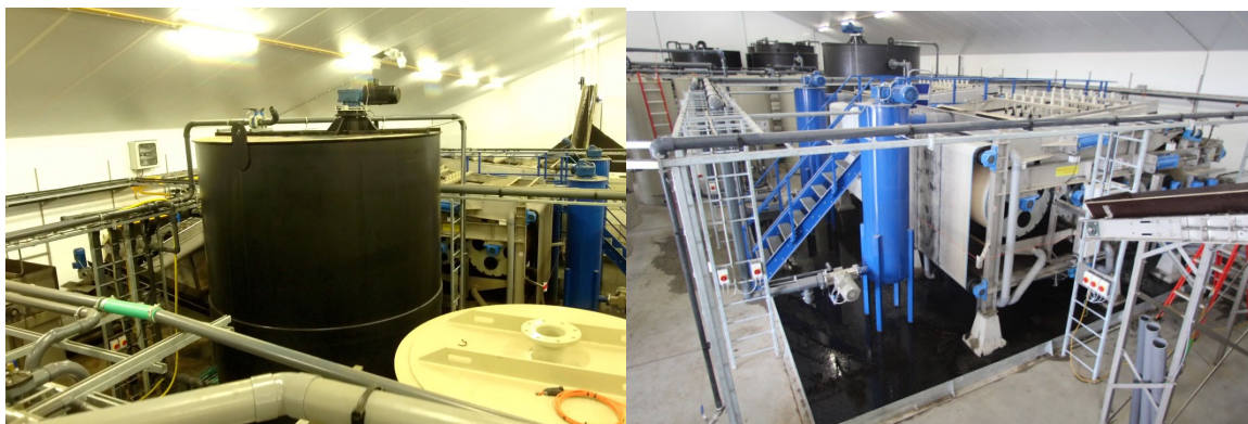
Abbildung 97: Teile der Aufbereitungskaskade der Kumac-Anlage in Deurne
