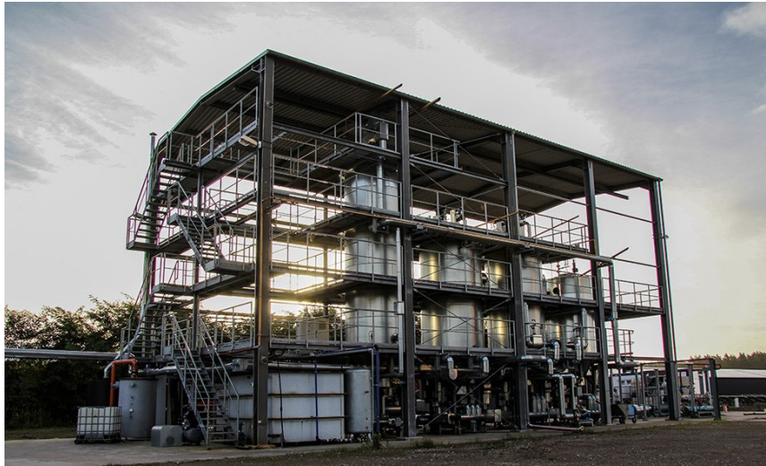
Abbildung 36: Beispiel einer HTC-Anlage
