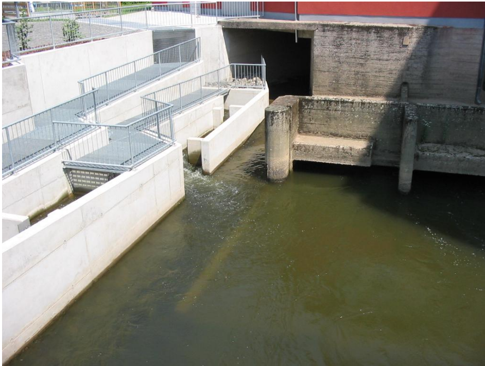
Abb. A.9: Unterwasseransicht der Wasserkraftanlage Klinkelsche Mühle in Gießen (Hessen) mit korrekter Anordnung des Einstiegs in die Fischaufstiegsanlage
