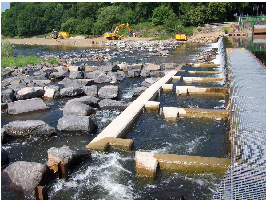
Abb. A.24 Fischaufstiegsanlage (Buisdorf/Sieg, NRW), nachträglich installierter Vertical Slot Pass in der seitlichen Verschneidung (Quelle: Nemitz).
