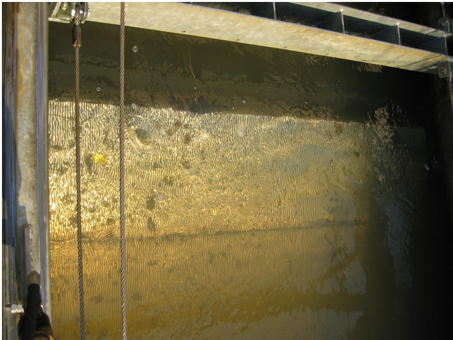
Abb. B. 6: Feinrechen in Betrieb
