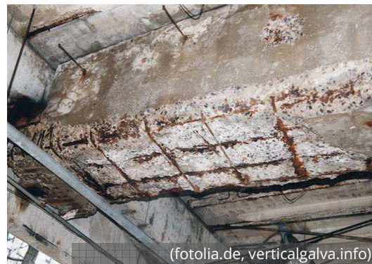
Korrosion der Stahlbewehrung
