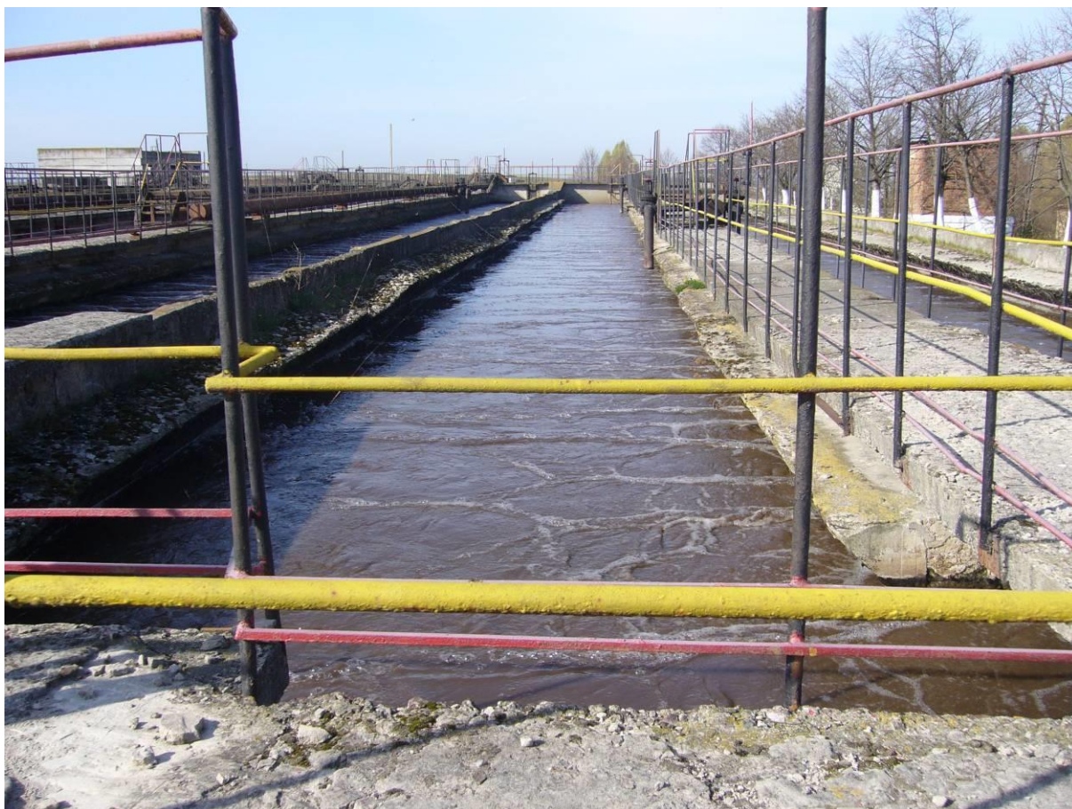
Rysunek 12 Komory napowietrzania w oczyszczalni ścieków w Nowowołyńsku
