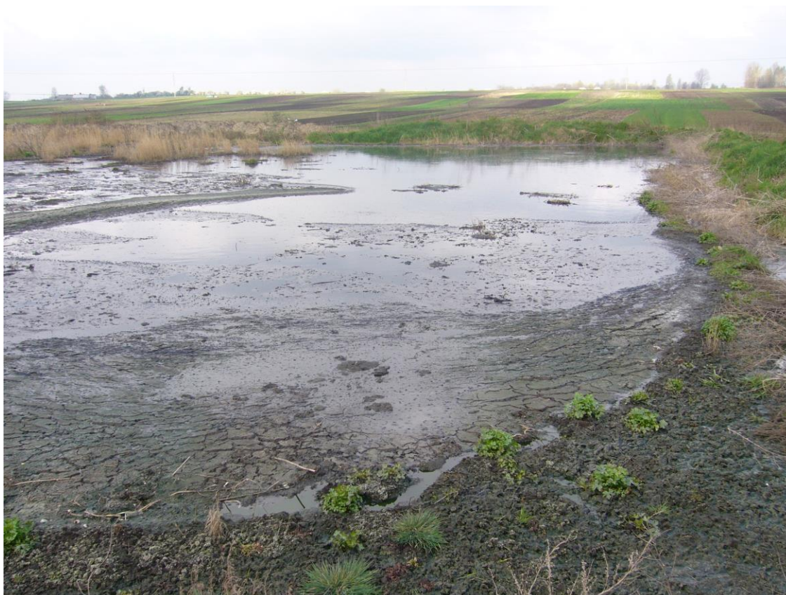
Rysunek 9 Przepełnione poletka osadowe na terenie oczyszczalni ścieków w Czerwonogradzie.
