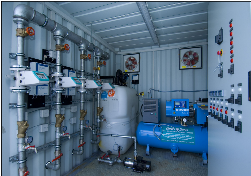
Foto 10: Anlage zur Ölabsaugung (Quelle: Züblin)
