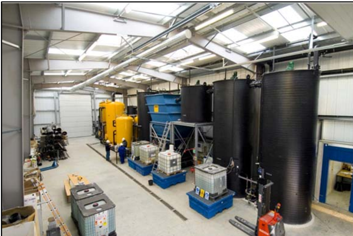
Abb. 3: Blick in die Grundwasserreinigungsanlage (Quelle: Züblin)
