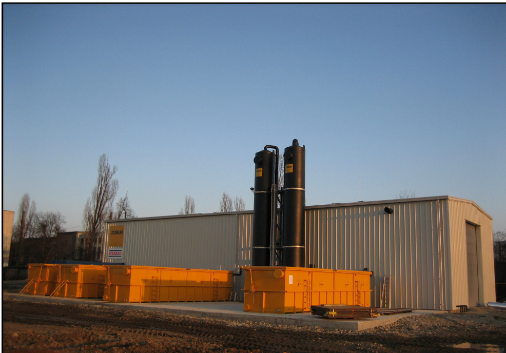
Foto 15: Grundwassersanierungsanlage (Halle mit Containern) (Quelle: Züblin)
