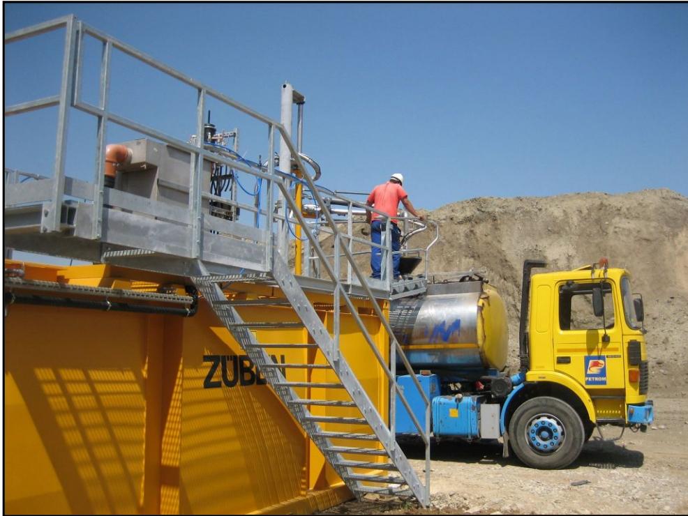
Foto 12: Übergabestation zum Abtransport der bereitgestellten Phase (Quelle: Züblin)
