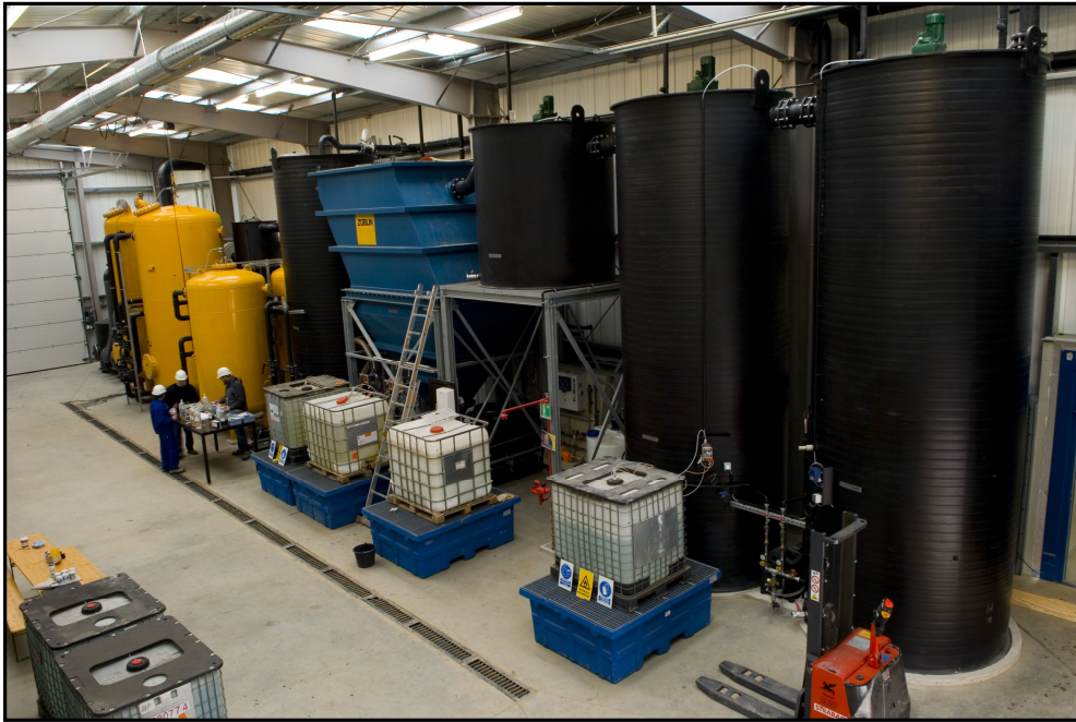
Foto 14: Grundwasserreinigungsanlage (Quelle: Züblin)
