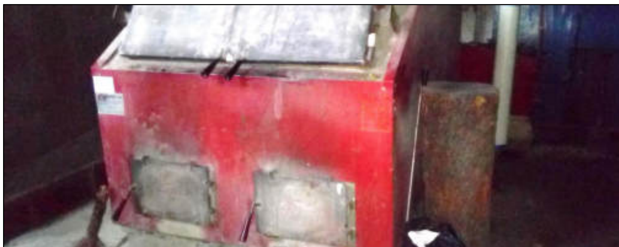
Abb. 121: Alter Heizkessel in einer Schule
