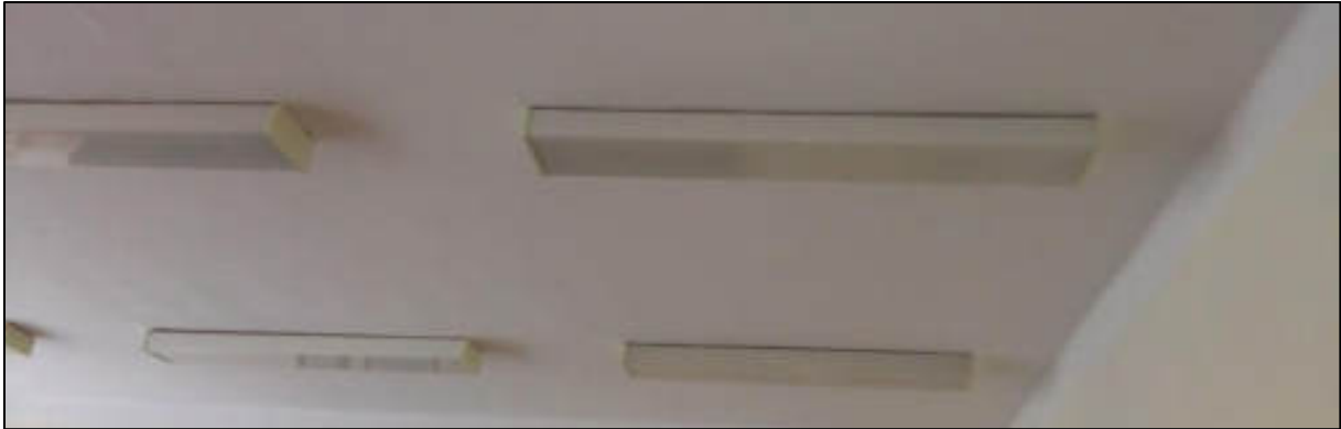
Abb. 120: Häufig vorgefundene konventionelle Beleuchtung mit größerem Einsparpotenzial
