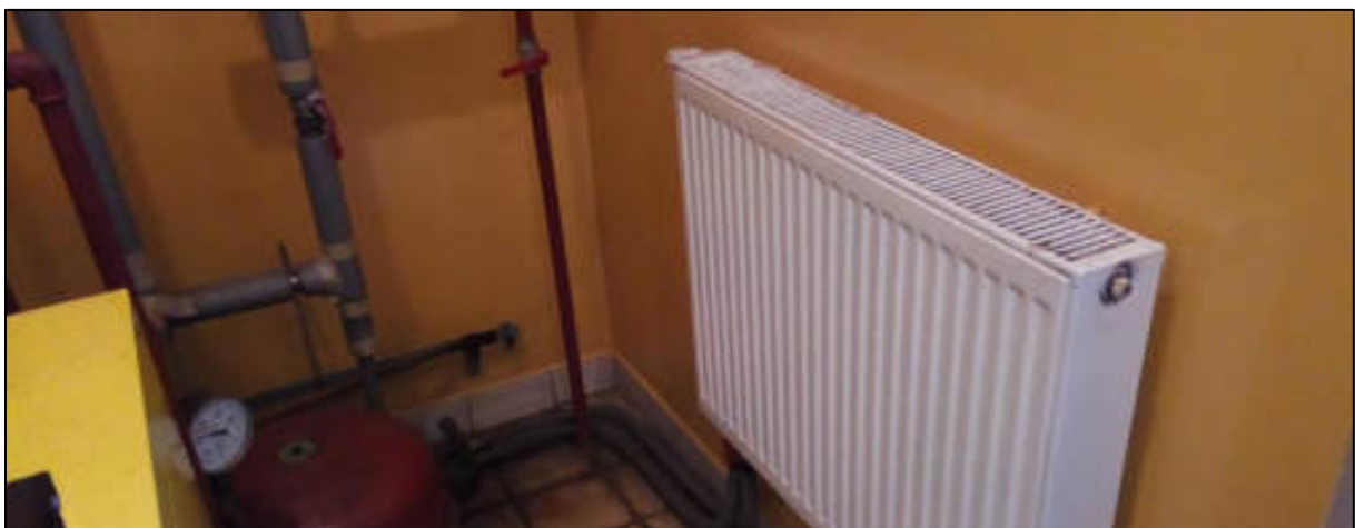
Abb. 123: Heizkörper in einem Raum ohne Heizenergiebedarf
