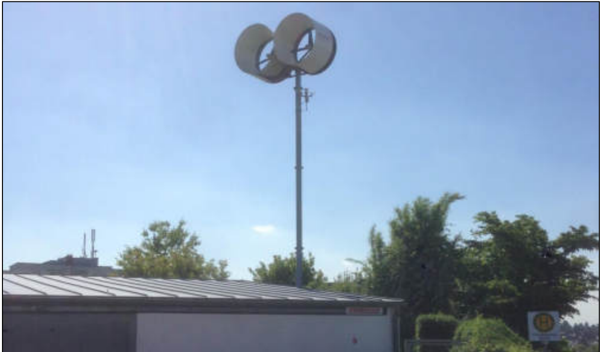
Abb. 85: Kleinstwindkraftanlage an einem Wohngebäude
