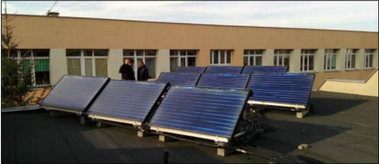
Abb. 74: Solarthermieranlage auf dem Dach einer Schule in Hajnówka
