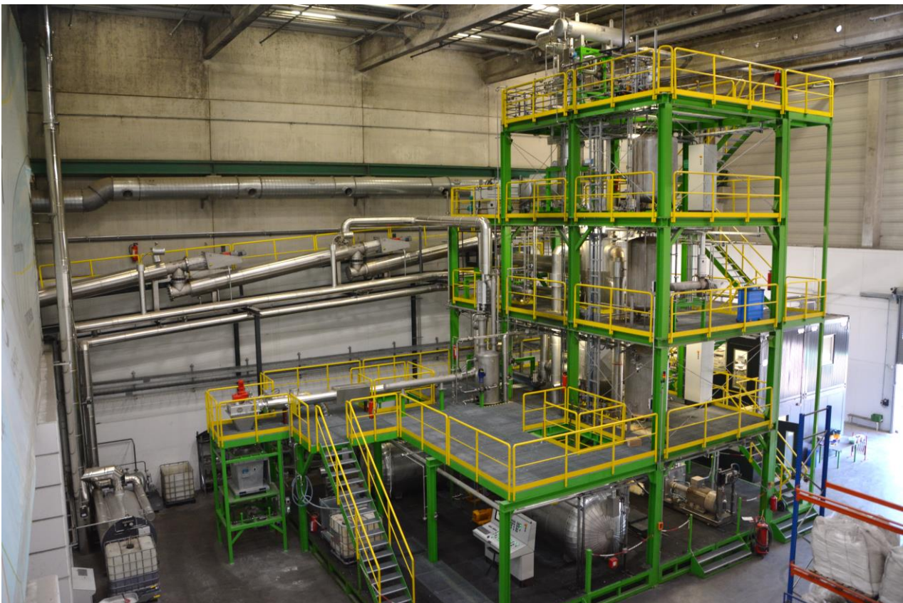
Abbildung 5-1: Pilotanlage der Recenso GmbH am Standort Ennigerloh
