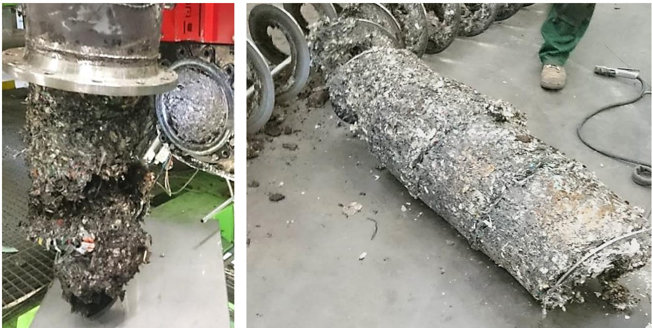
Abbildung 5-12: Blockaden im Zuführsystem der Dieselwest-Anlage bei der Behandlung von vorsortierten Kunststofffraktionen
