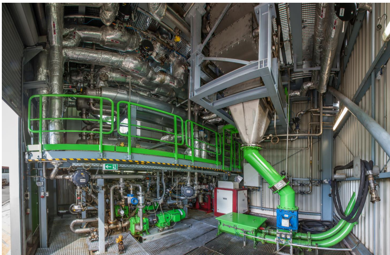
Abbildung 5-21: Unterteil des Kokskühlers und Rohrkettenförderer am Reaktor der Firma Pyrum Innovations, Standort Dillingen
