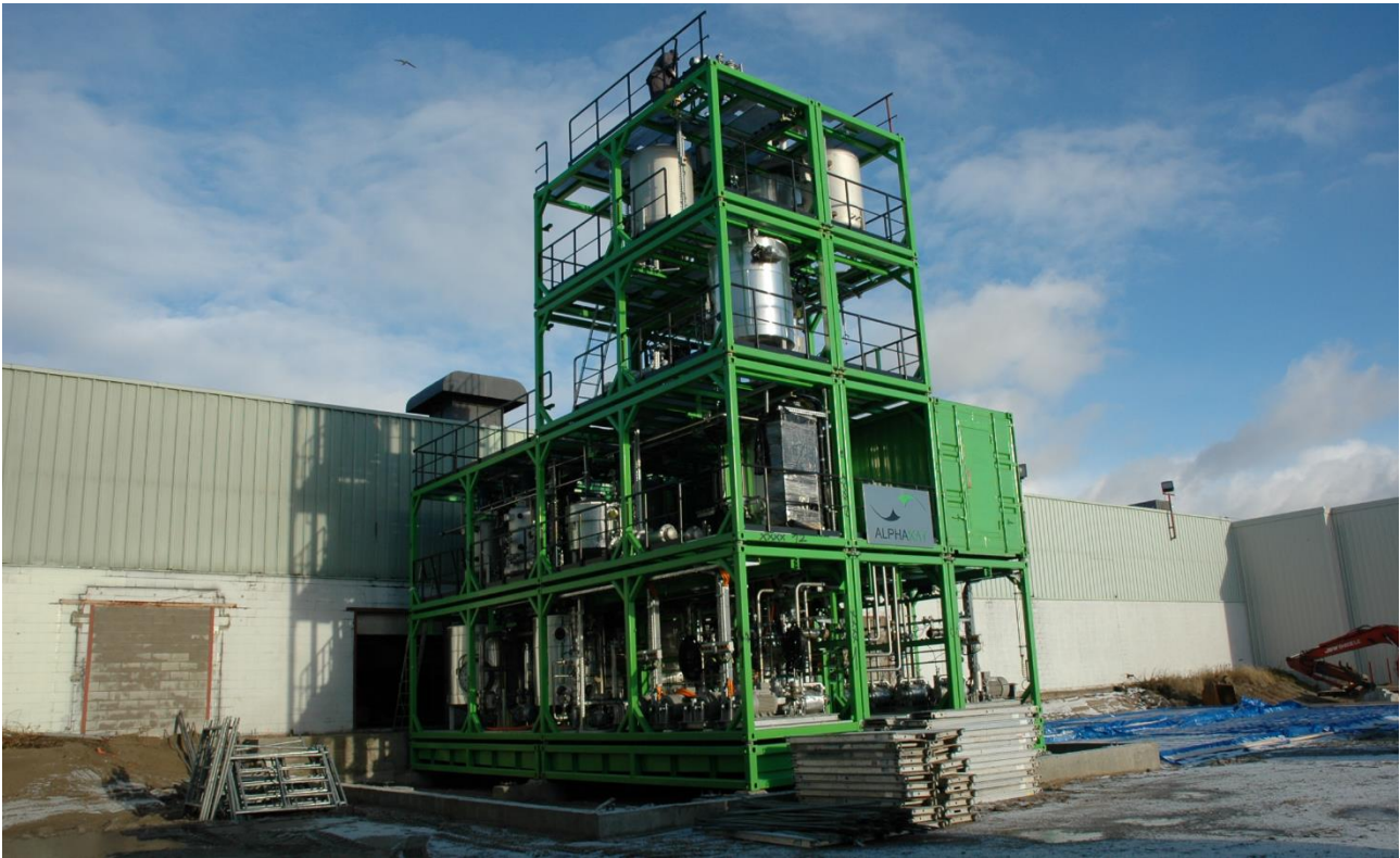
Abbildung 5-2: Pilotanlage Nanofuel der Recenso GmbH am Barrie, Kanada
