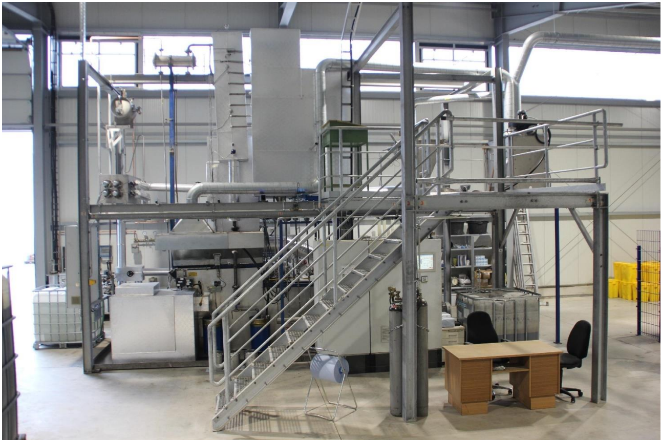
Abbildung 5-15: Technikumsanlage der Logmed Cooperation in Halberstadt
