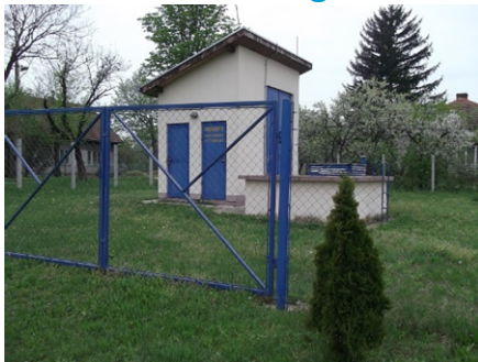
Kleine Wasserversorgung im Dorf Tornjoš
