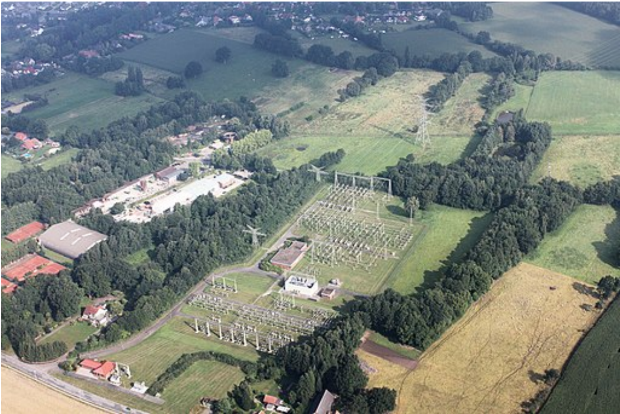
Abbildung 13: Umspannwerk mit Freiluftschaltanlage
