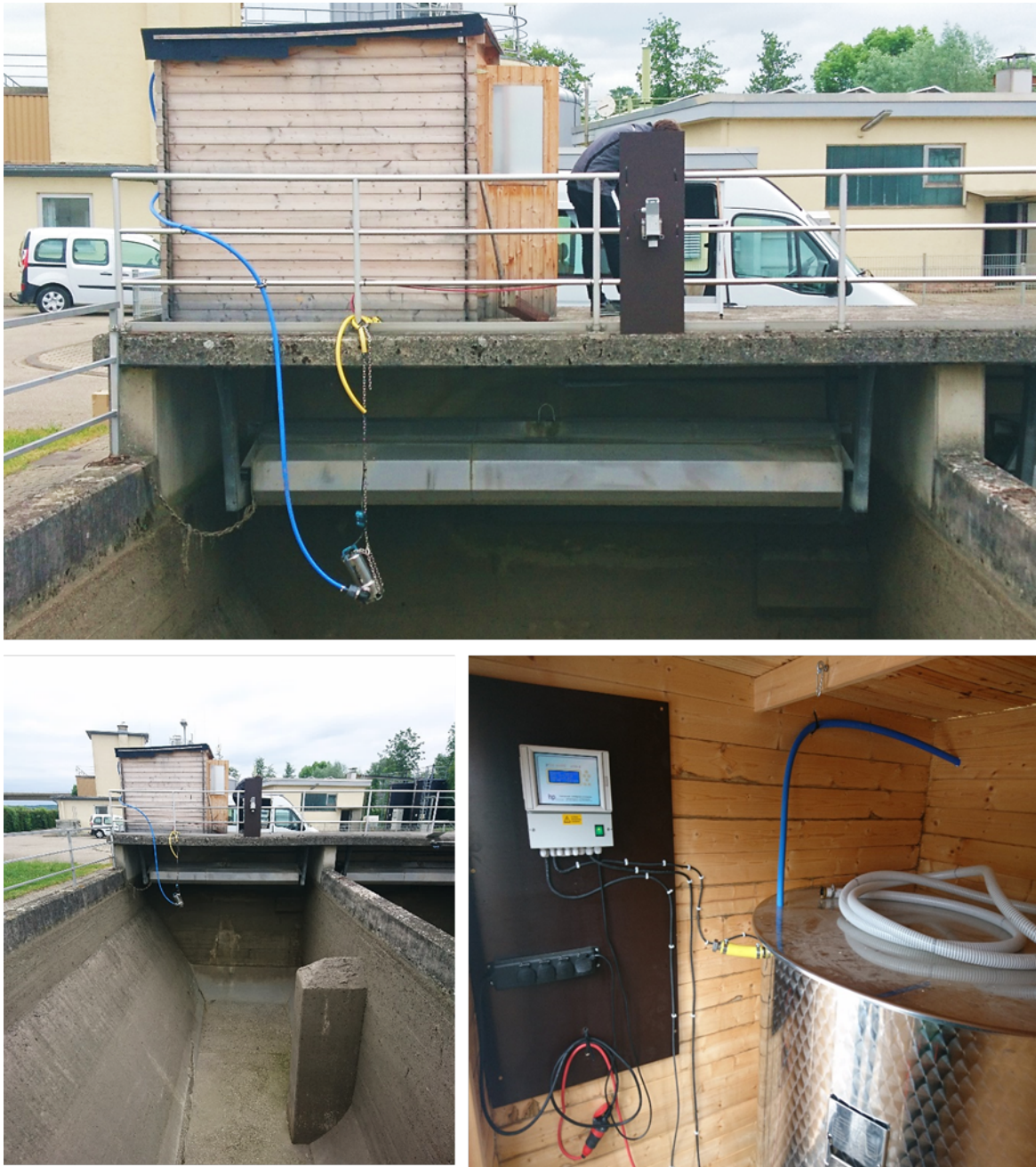
Abbildung 6: RÜB und Probennehmer auf der KA Eppingen
