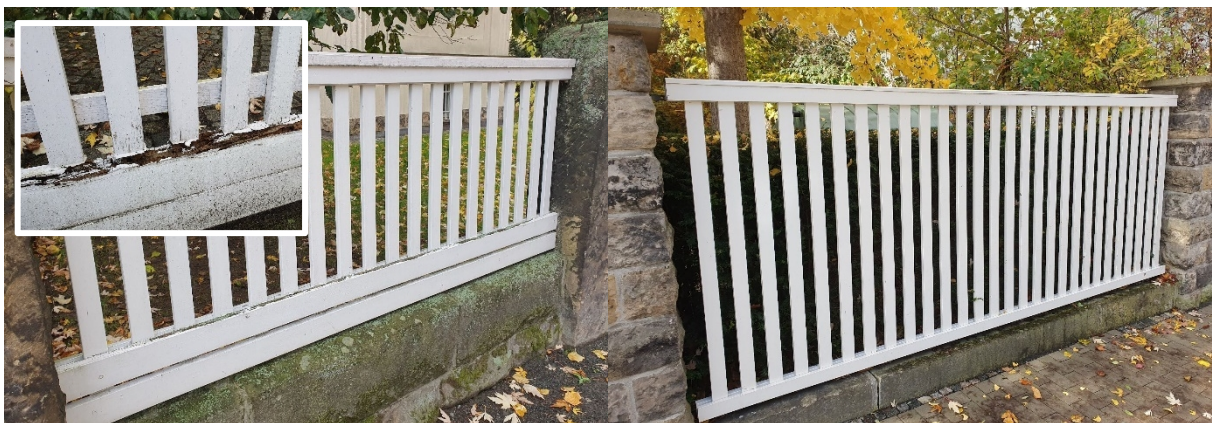
Abbildung 4: Zaunanlage aus deckend beschichtetem, unbehandeltem Nadelholz (links) mit teils typischen Schäden (kleines Foto) und Ersatzausführung in Aluminium (rechts)
