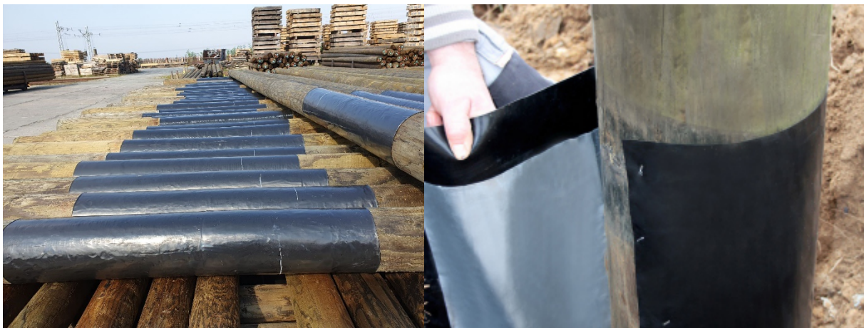
Abbildung 10: Schutz der Erd-Luft-Zone von Holzmasten mit Bandagen; links werkseitig angebracht, rechts als Nachschutz vor Ort
