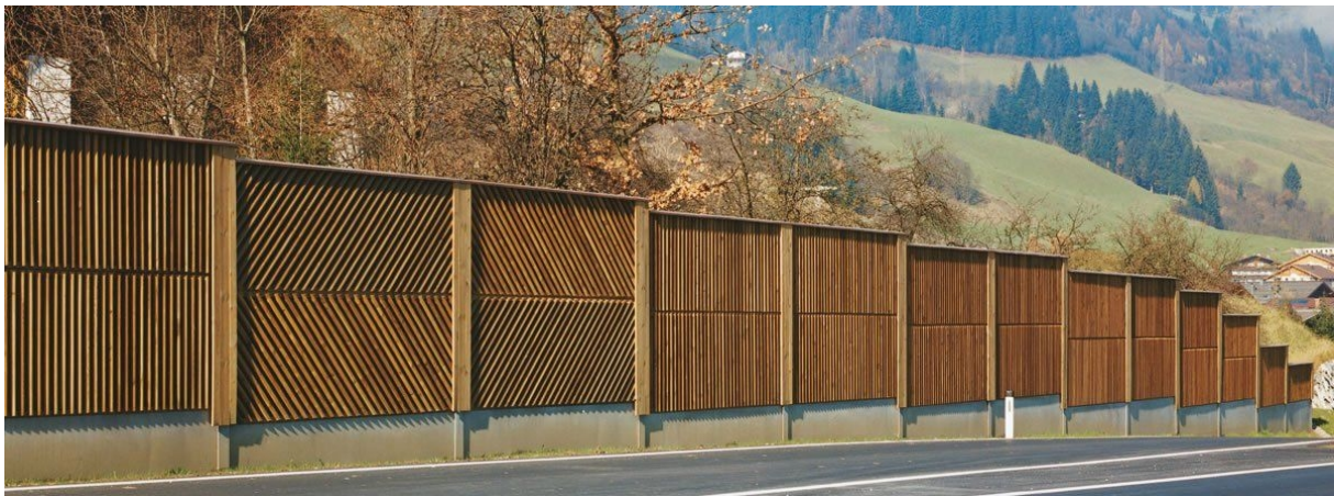
Abbildung 12: Typische Lärmschutzwand aus Holz
