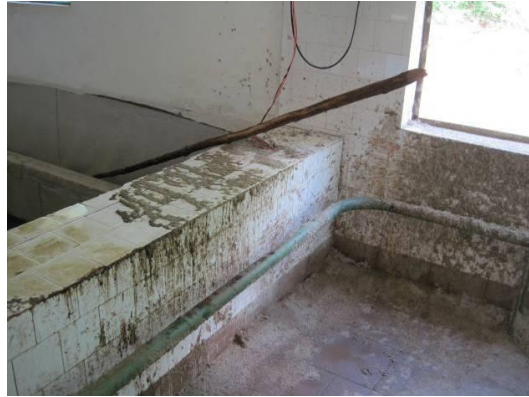
Abbildung 8: Filterbecken der Wasseraufbereitungsanlage Văliug (Quelle: COPLAN AG)
