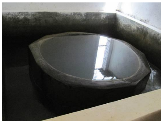
Abbildung 7: Schnellfilter der Wasseraufbereitungsanlage Tomești (Quelle: COPLAN AG)
