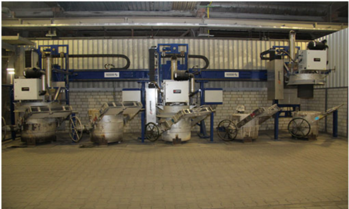
Abbildung 8: Halbautomatische Gesamtanlage zur kontrollierten Pfannenbeheizung bzw. -trocknung mit 5 Parkplätzen und drei Beheizungssysteme
