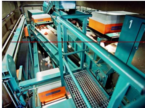
Abbildung 2-4: Nah-Infrarottechnik-Aggregate der A.R.T.-Sortieranlage. 6
