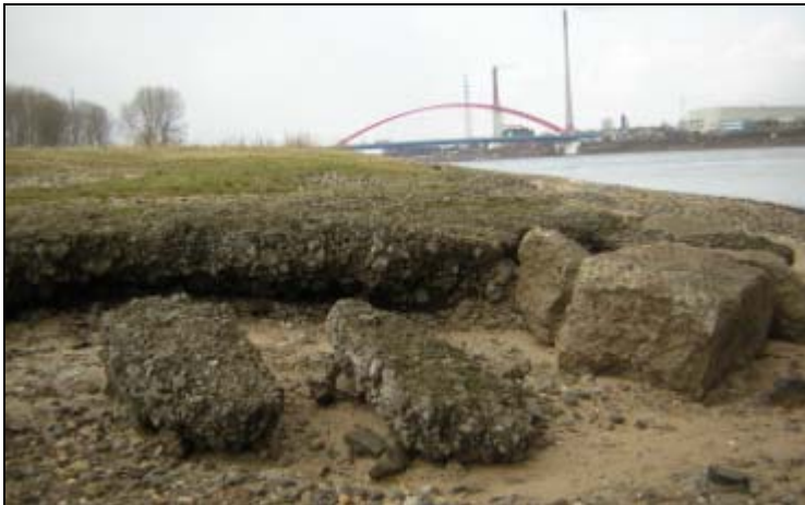
Situation Februar 2006: In Teilbereichen wurden im Streckenabschnitt in den 50er Jahren Schlacken zur Ufersicherung eingesetzt. Das Material ist zwischenzeitlich zu einer festen Schicht verbacken und kann nur mit großem Aufwand aufgebrochen werden.
