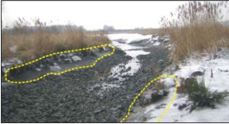
Einlaufbereich im Überblick mit den gekennzeichneten Erosionsstrecken.
