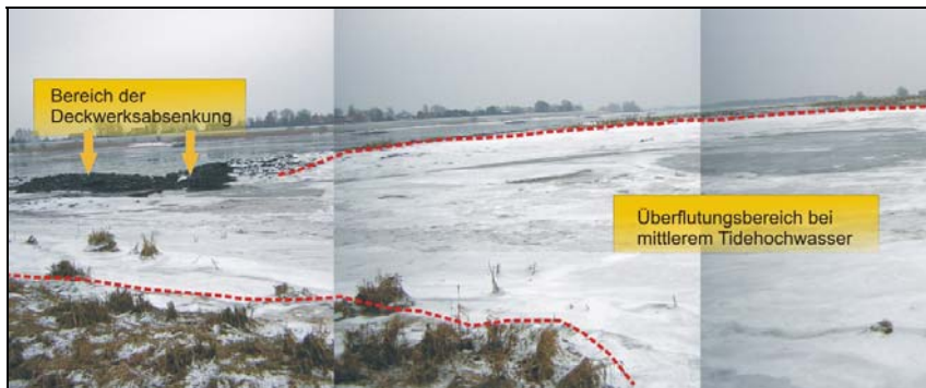
Gesamtübersicht der Deckwerks- und Hinterlandabsenkung.
