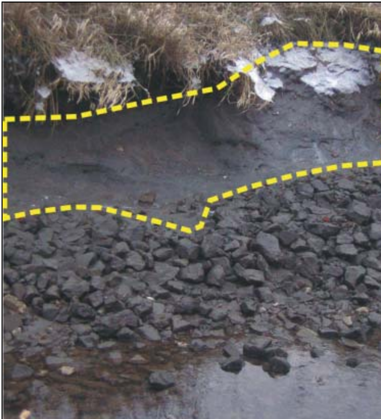
Detailaufnahme aus dem Bereich des Einlaufbereiches: Durch die hohe Fließgeschwindigkeit der ein- und ausströmenden Tide ist die Steinschüttung teilweise beschädigt. Es bildet sich selbsttätig ein neues Uferprofil.
