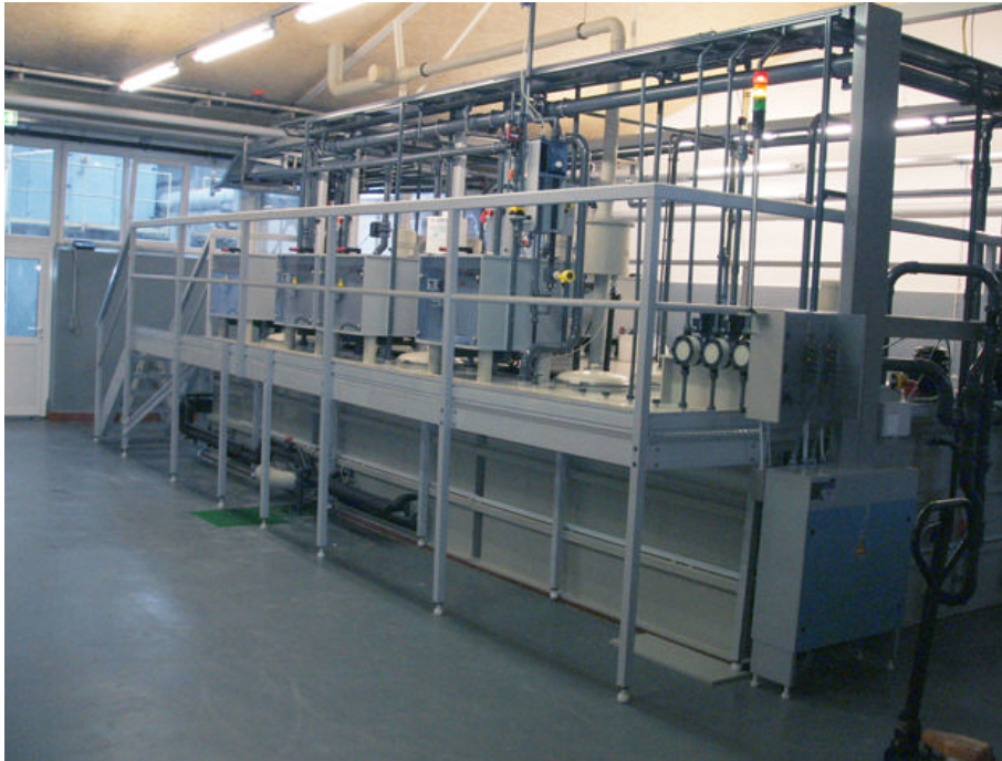
Abbildung 11 : Foto der Regenerationsanlage
