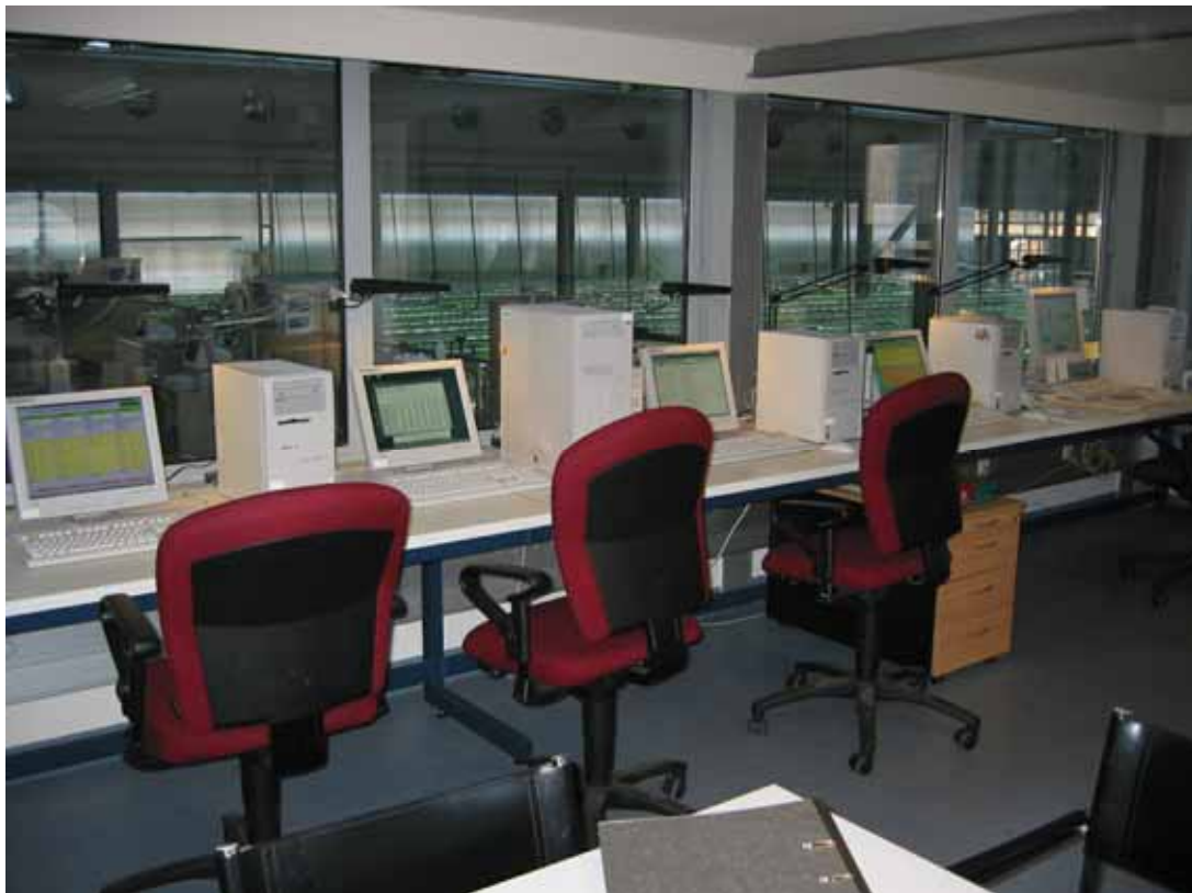
Abb. 4: Leitwarte der FSA (Quelle: Autoren)
