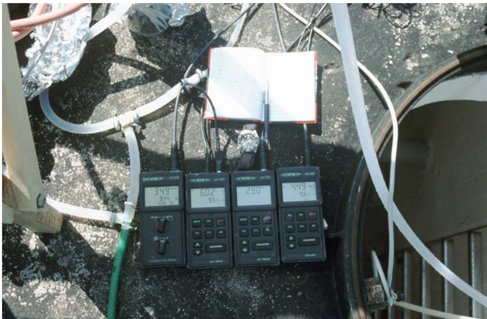
Abb. 20. WTW-Messelektroden in der Durchfluss-Messzelle zur kontinuierlichen Messung der Randparameter (Foto: I. Stodian).
