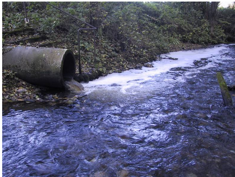
Fotografia 3: Vyústenie odpadu ČOV Revúca
