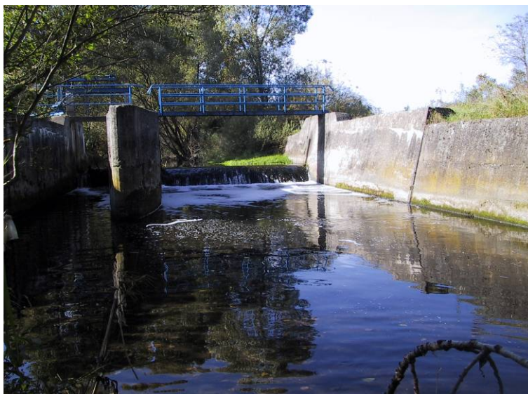
Foto 4: Ableitung im Bereich des Wasserreservoirs bei Miková
