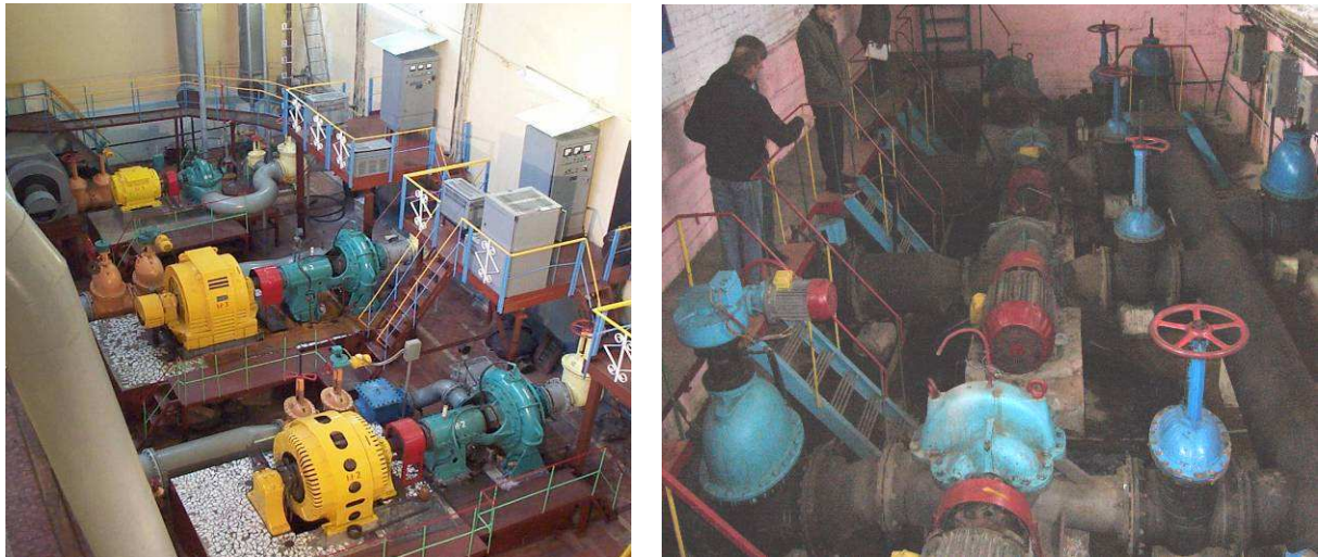
Малюнок 8: Сучасні (м. Чернігів, зліва) і застарілі насосні станції (м. Червоноград, справа)
