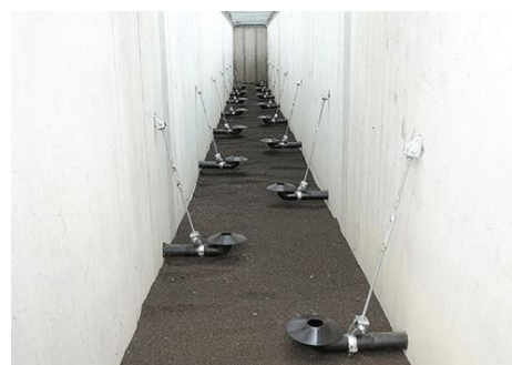
Semizentrale Behandlungsanlage (© OST)
