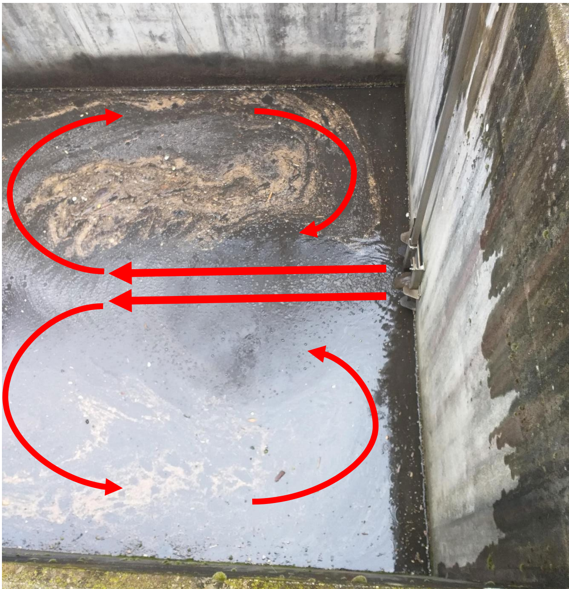
Abbildung 8: Ungleichmäßiges Strömungsbild im Becken D durch ungünstige Einlaufgestaltung
