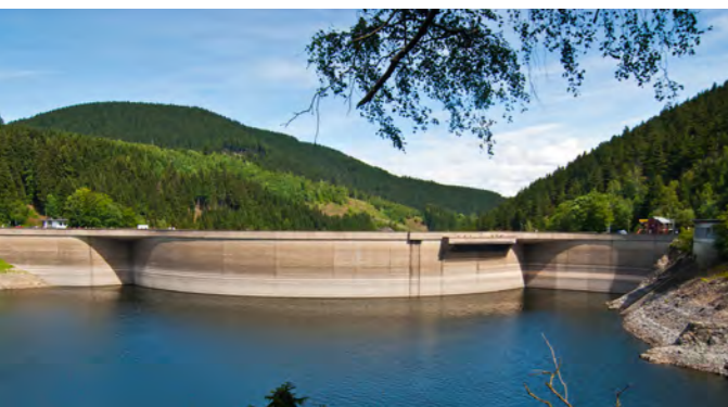
Starke Wasserstandsschwankungen zeichnen sich an Staumauer und Uferböschungen ab. Foto: Hans Peter Denecke / Fotolia.de
