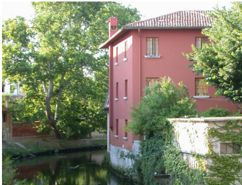
Biozidauswaschungen aus Fassaden können wie hier Wasserlebewesen schädigen und Oberflächengewässer gefährden. Foto: © N. Schmitz / Pixelio.de
