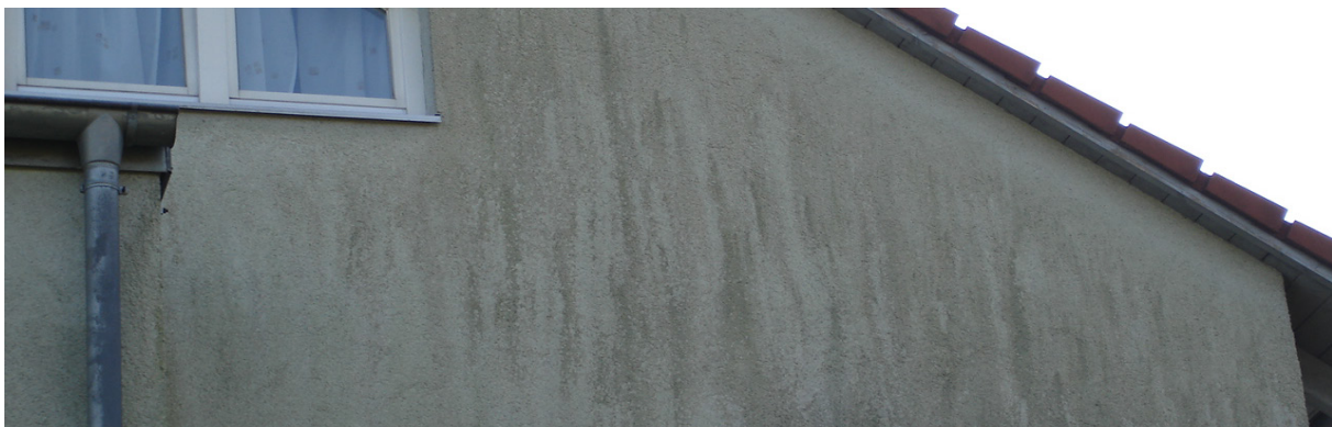
Algen und Pilze an einer Hausfassade
