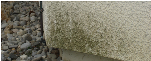
Algen und Pilze an einer Hausfassade Foto: © H. Bartholemy/ Bundesverband Farbe Gestaltung Bautenschutz
