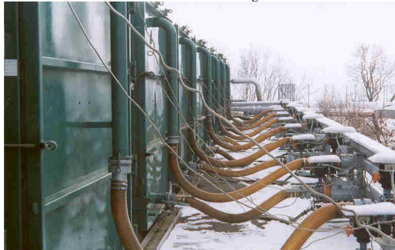
Bild b. Rotteboxen mit installierter Ablufferfassung und Sickerwasserbehandlung
