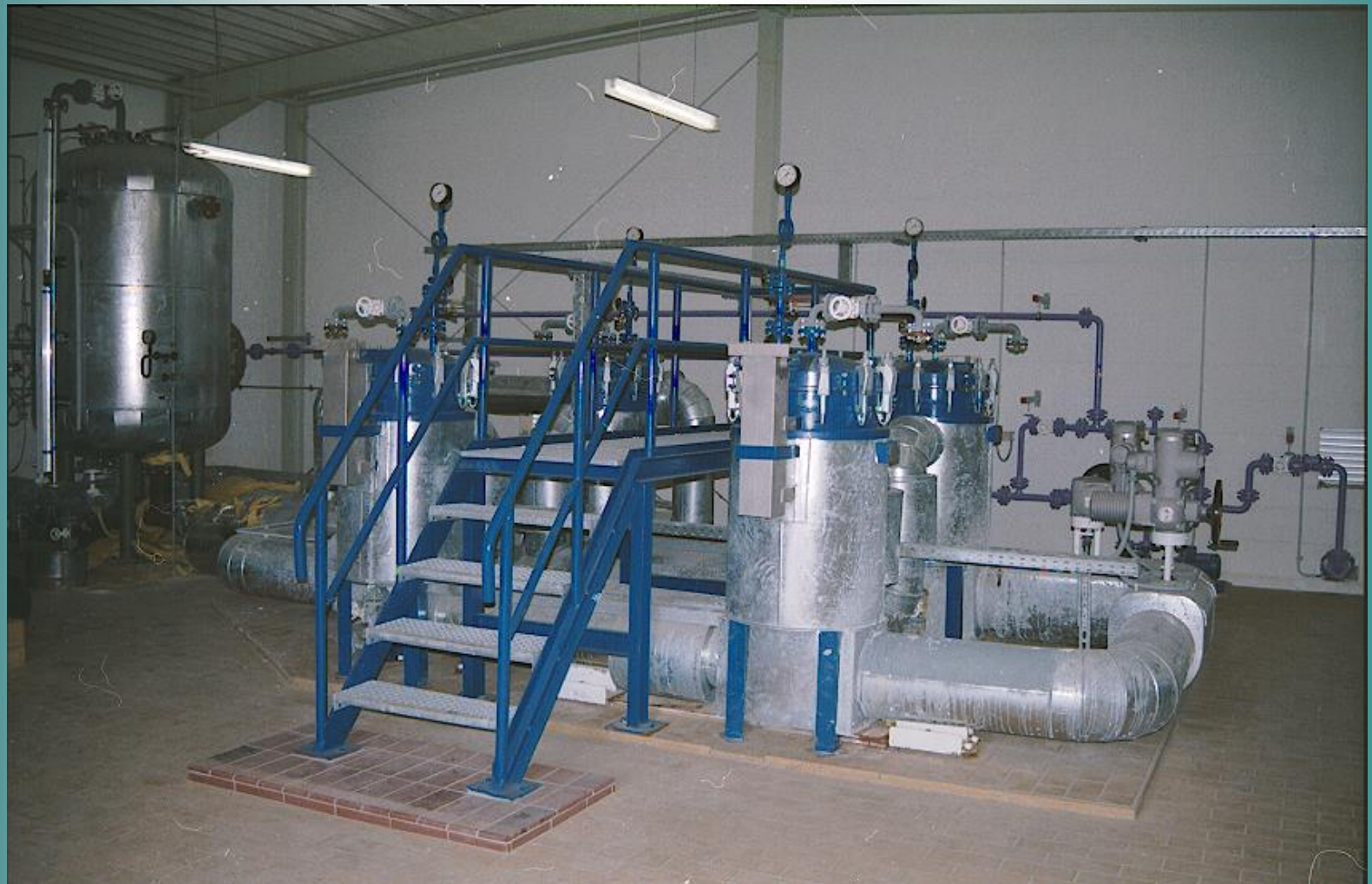
Filterhaus 2 Зал фильтров 2
