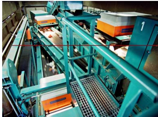
Abbildung 2-4: Nah-Infrarottechnik-Aggregate der A.R.T.-Sortieranlage. 6
