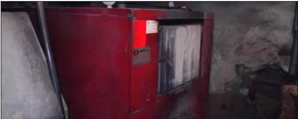
Rys. 133: Kocioł lokalnej sieci ciepłowniczej w centrum Narwi
