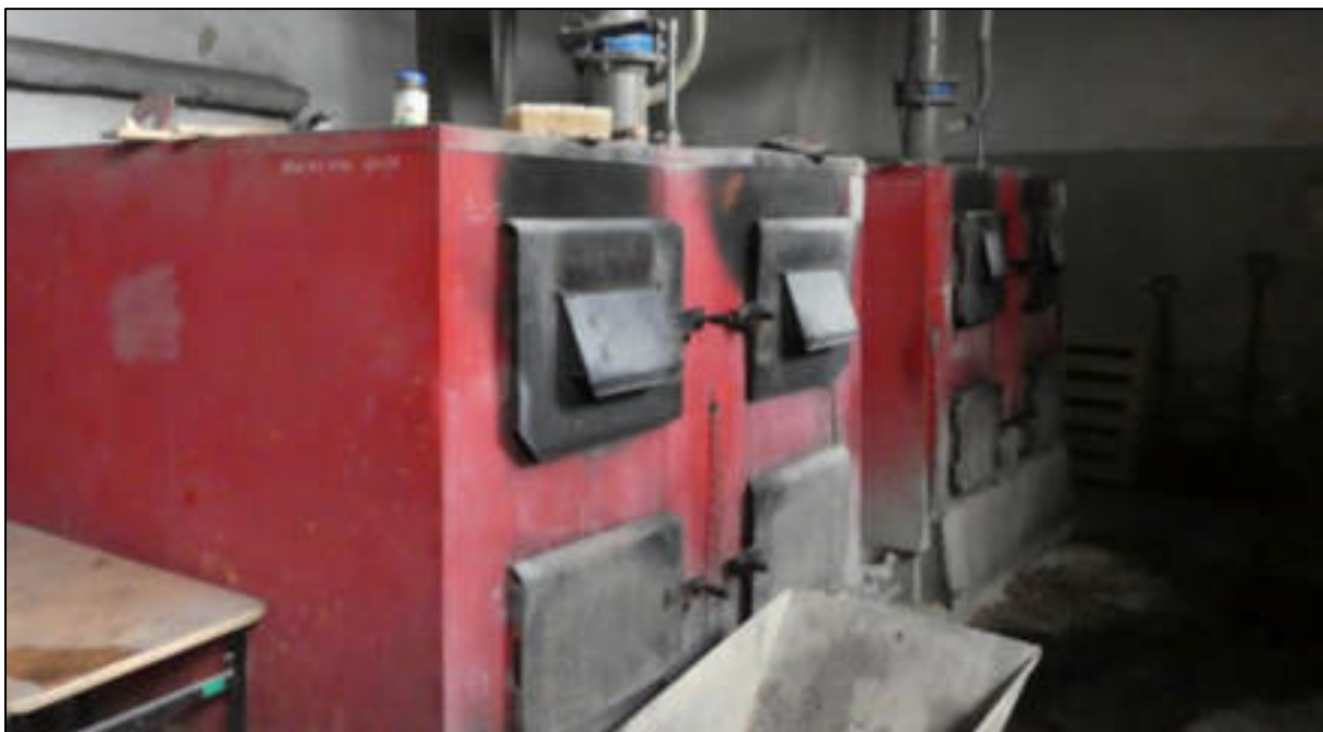
Rys. 115: Kocioł węglowy w budynku Szkoły Podstawowej w Hajnówce
