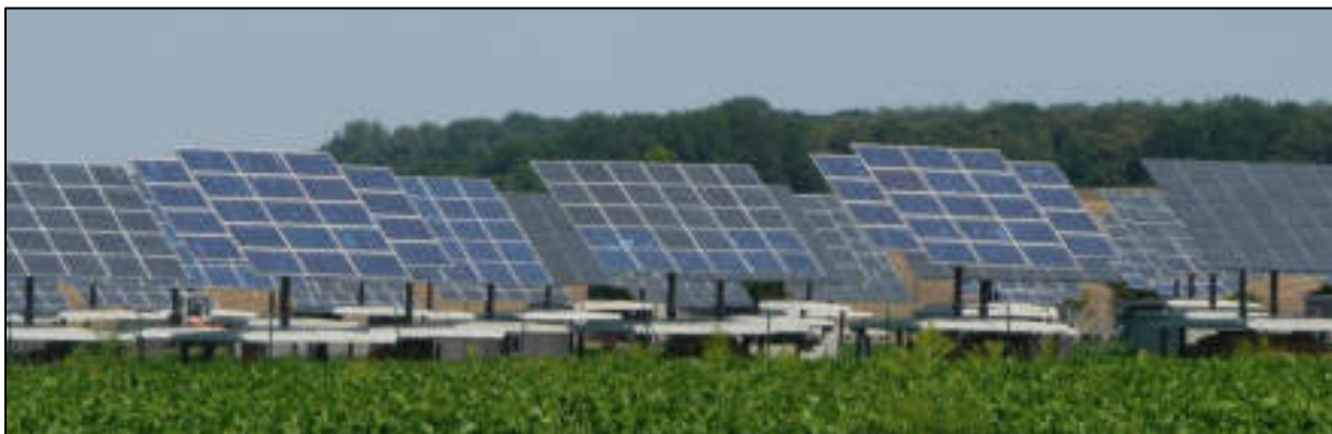
Rys. 75: Instalacje fotowoltaiczne (tutaj na wolnej powierzchni)
