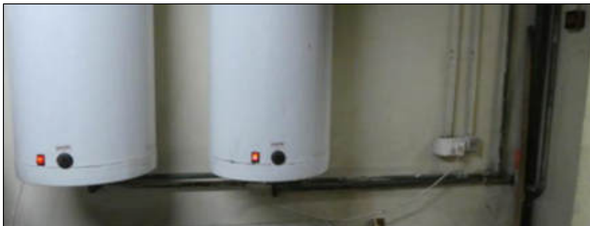
Rys. 113: Centralne ogrzewanie wody z niezaizolowanymi rurami w Domu Kultury w Hajnówce
