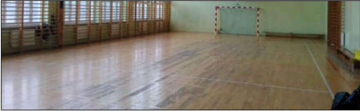
Rys. 130: Pokrycie podłogi hali sportowej uszkodzonej przez kapiącą wodę kondensacyjną
