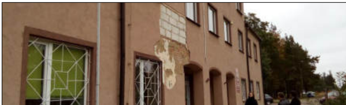
Rys. 117: Nieizolowane przegrody zewnętrzne budynku komunalnego
