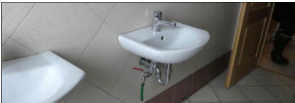
Rys. 114: Centralne ogrzewanie wody z niezaizolowanymi rurami w Domu Kultury w Hajnówce
