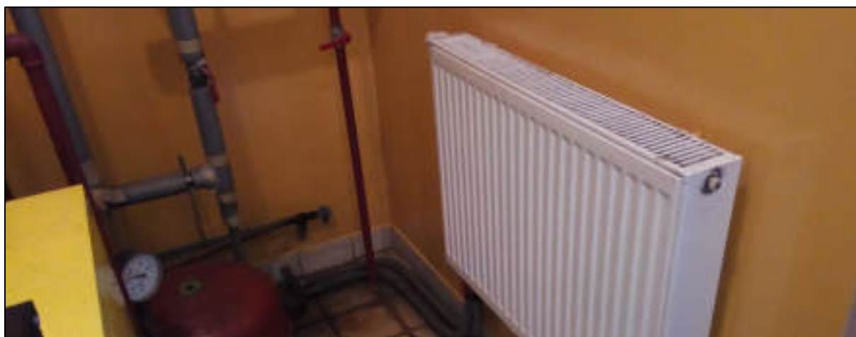
Rys. 123: Grzejnik w pomieszczeniu bez zapotrzebowania na energię grzewczą
