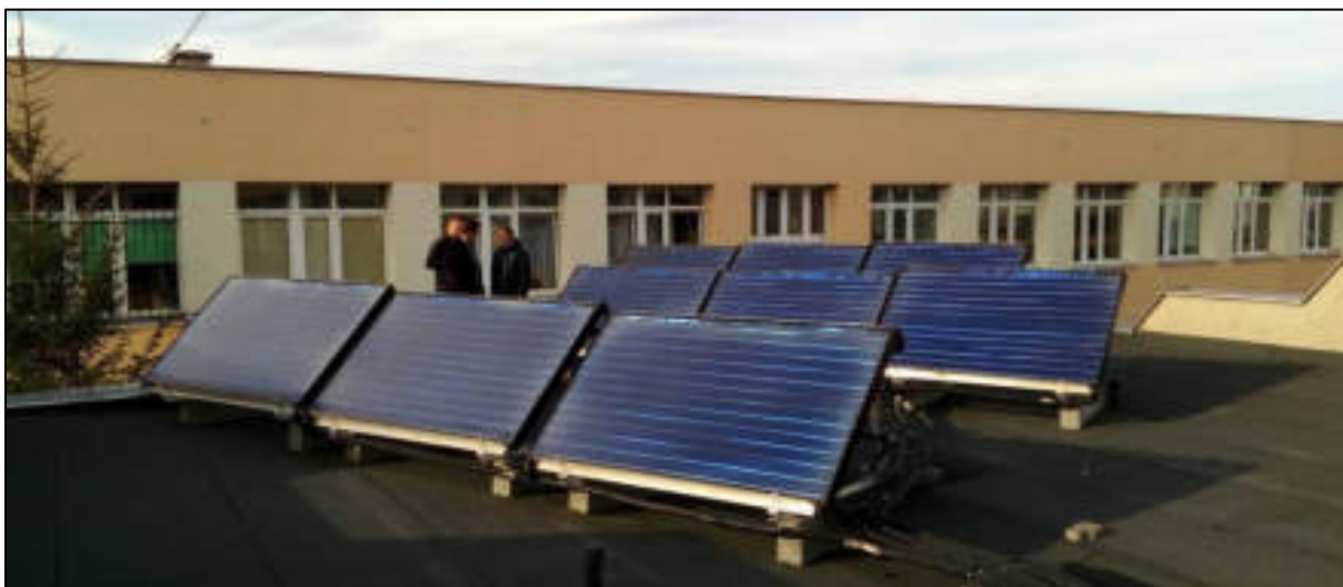
Rys. 74: Solarny system grzewczy na dachu szkoły w Hajnówce
