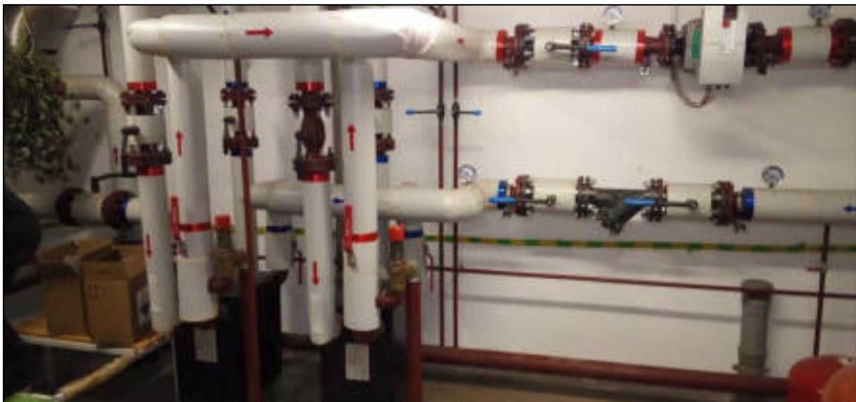
Rys. 107: Wymienniki ciepła w pomieszczeniu przyłączeniowym w Parku Wodnym w Hajnówce
