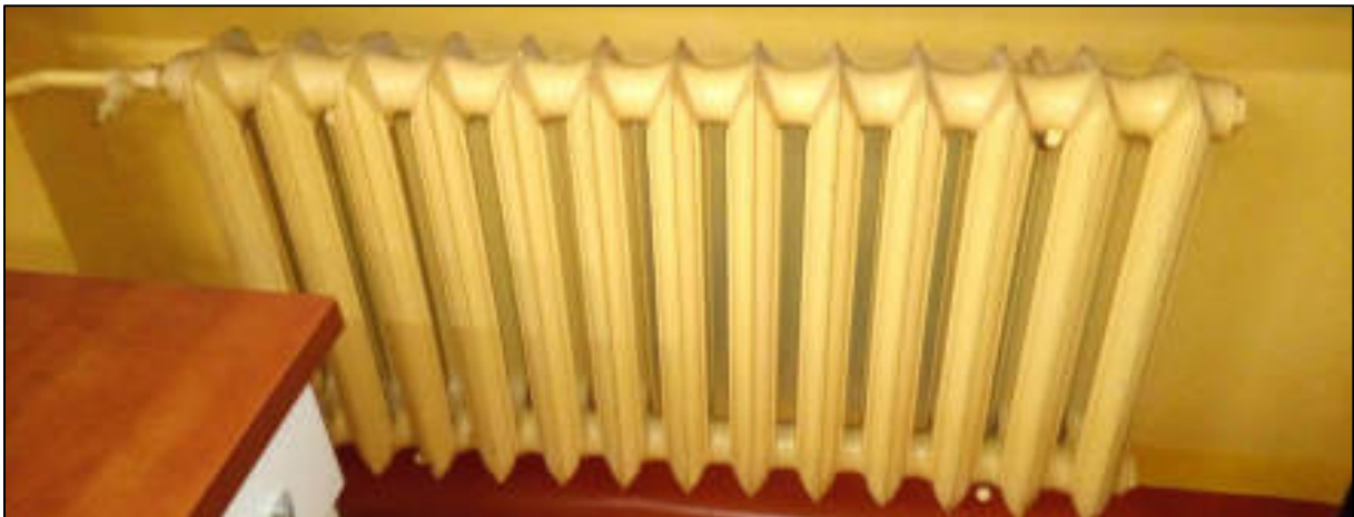
Rys. 124: Centralnie sterowany grzejnik bez własnego zaworu termostatycznego w jednej z oglądanych nieruchomości
