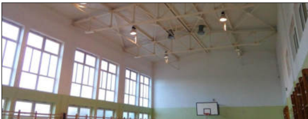
Rys. 129: Niezaizolowany sufit oglądanej hali sportowej
