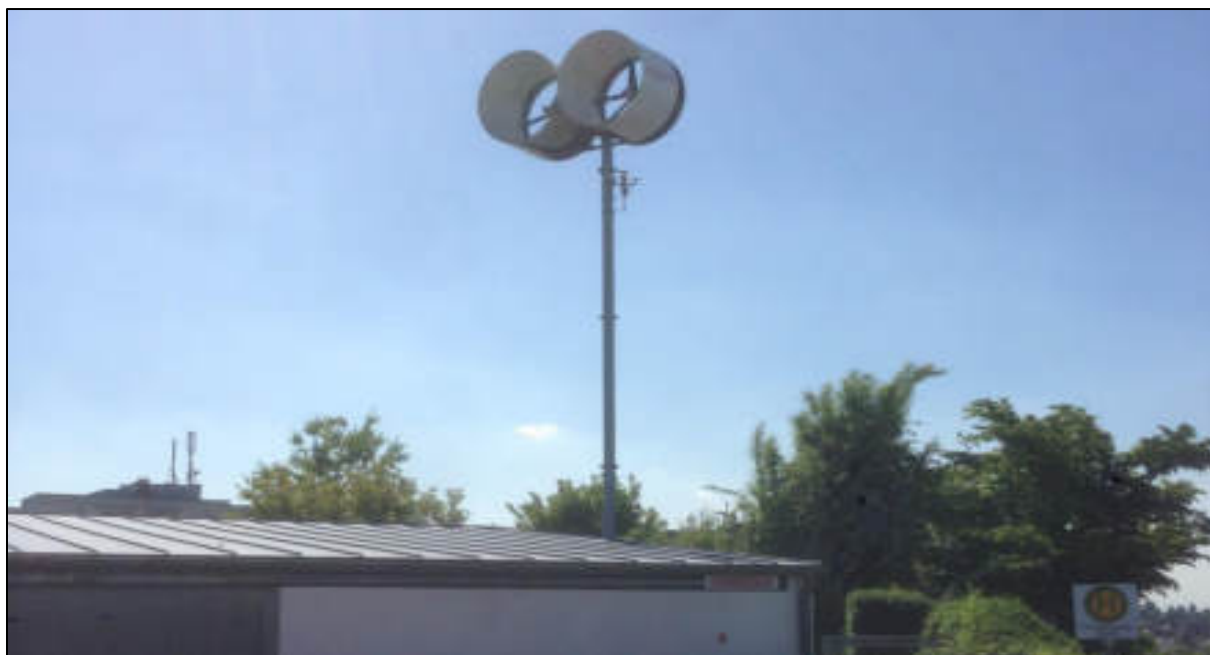
Rys. 85: Mała turbina wiatrowa na budynku mieszkalnym
