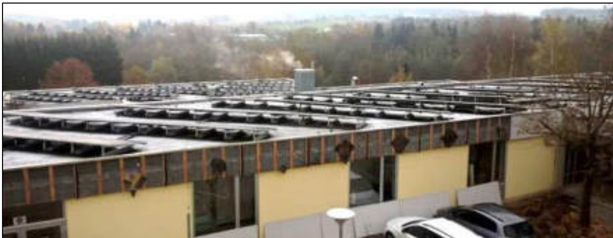
Rys. 179: Widok systemu fotowoltaicznego na szkole w Schwarzenbach nad Saale.
