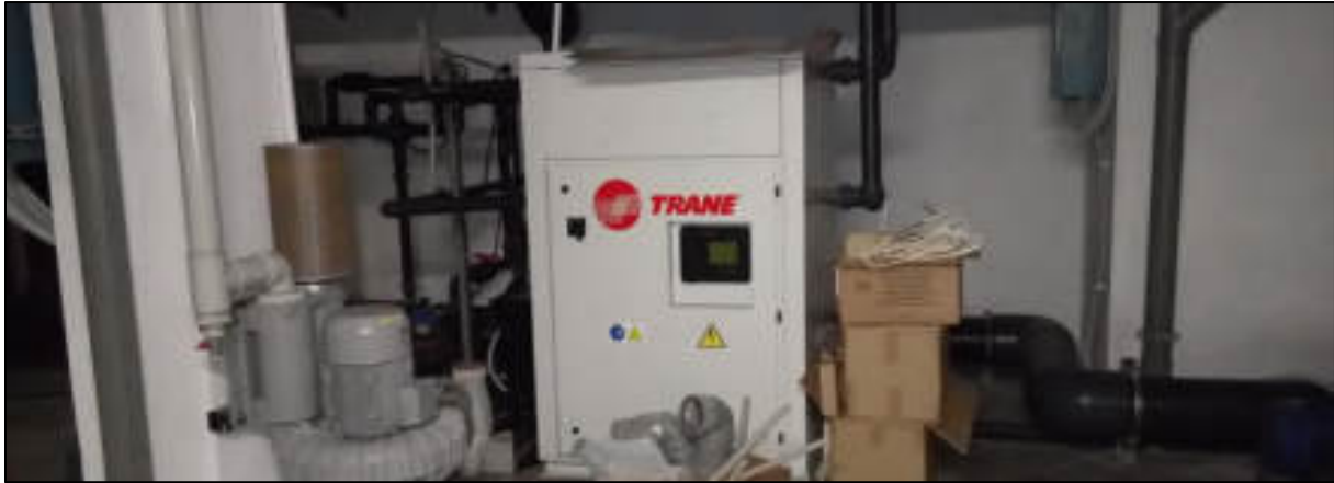
Rys. 106: Pompa ciepła do odzysku energii w Parku Wodnym w Hajnówce
