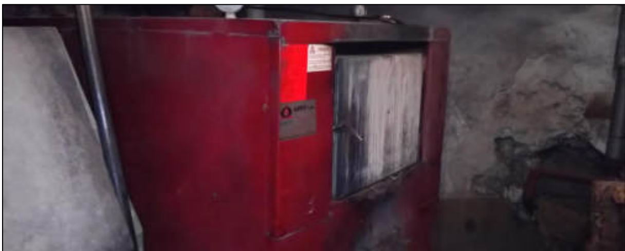
Abb. 133: Heizkessel des Nahwärmenetzes im Ortszentrum von Narew
