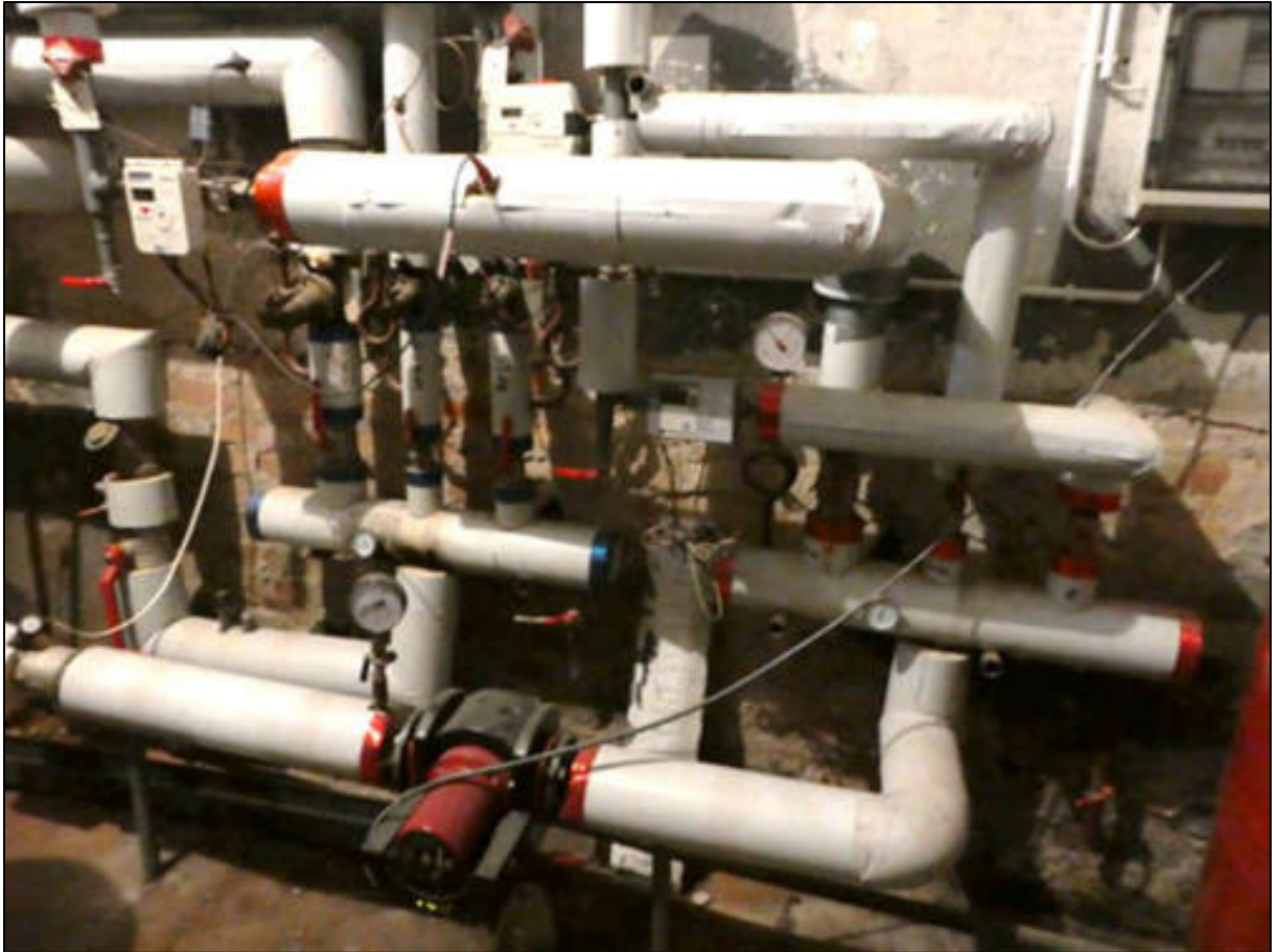
Abb. 110: Die Heizungsverteilung im Landratsam Hajnówka mit fehlendem Mischerventil und drei geregelten Pumpen
