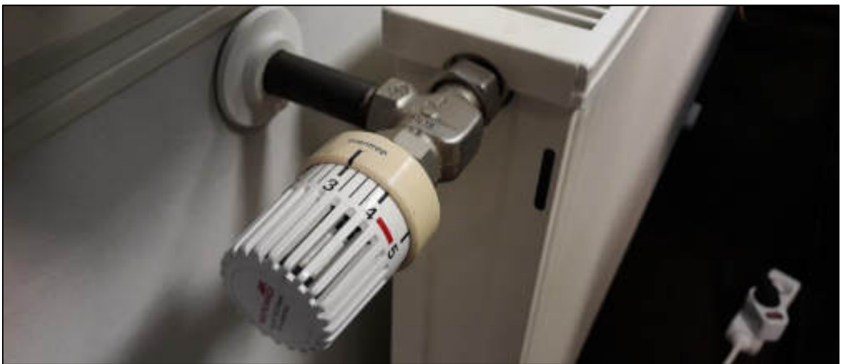
Abb. 126: Beispiel für ein einstellbares Heizkörper-Thermostatventil
