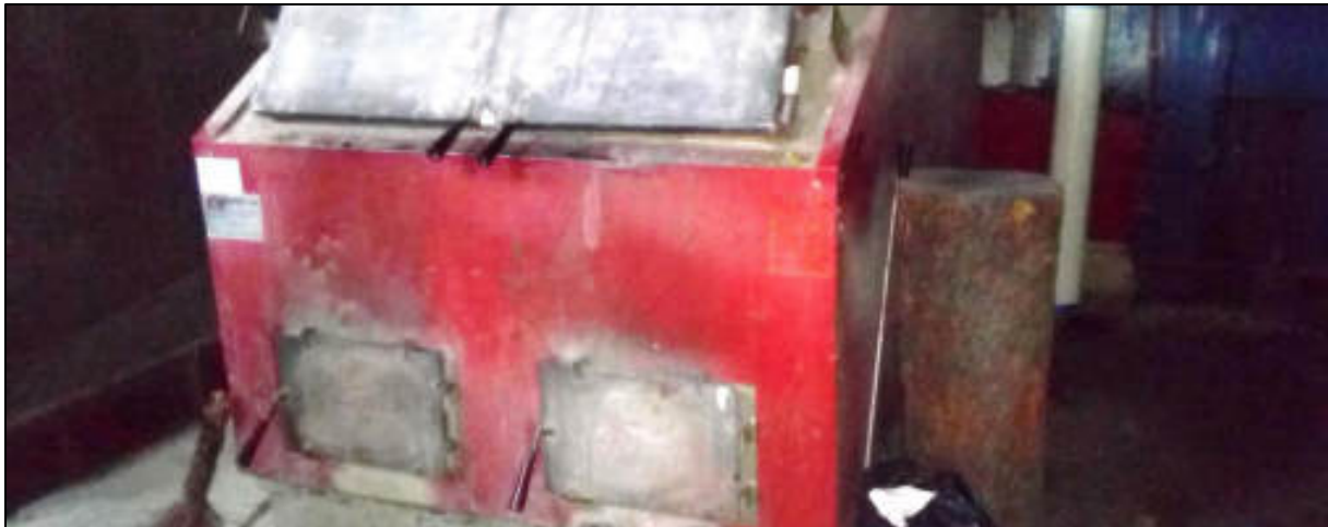
Abb. 121: Alter Heizkessel in einer Schule
