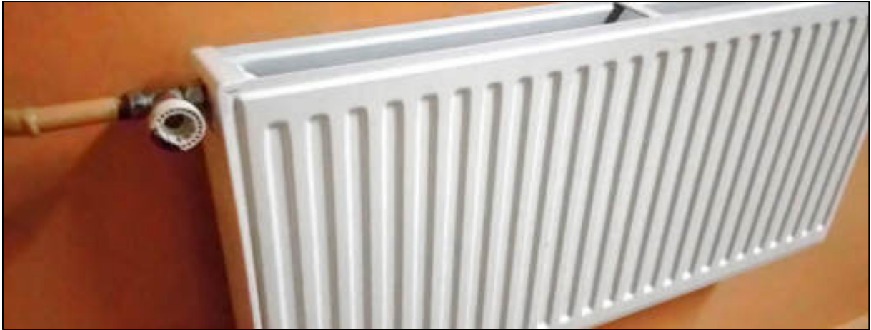
Abb. 125: Zentral gesteuerter Heizkörper ohne eigenes Thermostat in einer begangenen Liegenschaft
