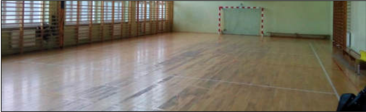
Abb. 130: Durch herabtropfendes Kondenswasser beschädigter Bodenbelag einer begangenen Sporthalle
