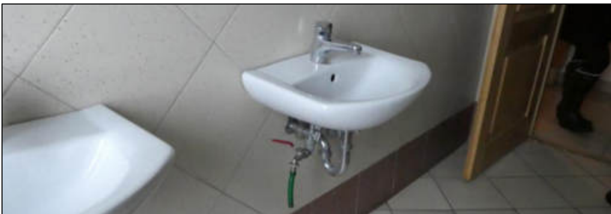
Abb. 114: Zentrale Warmwasserbereitung mit unisolierten Leitungen im Kulturhaus Hajnówka
