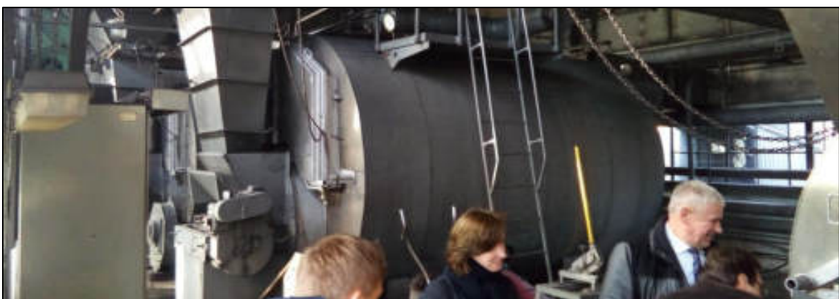
Abb. 131: Einer der drei großen Heizkessel des städtischen Fernwärmesystems der Stadt Hajnówka
