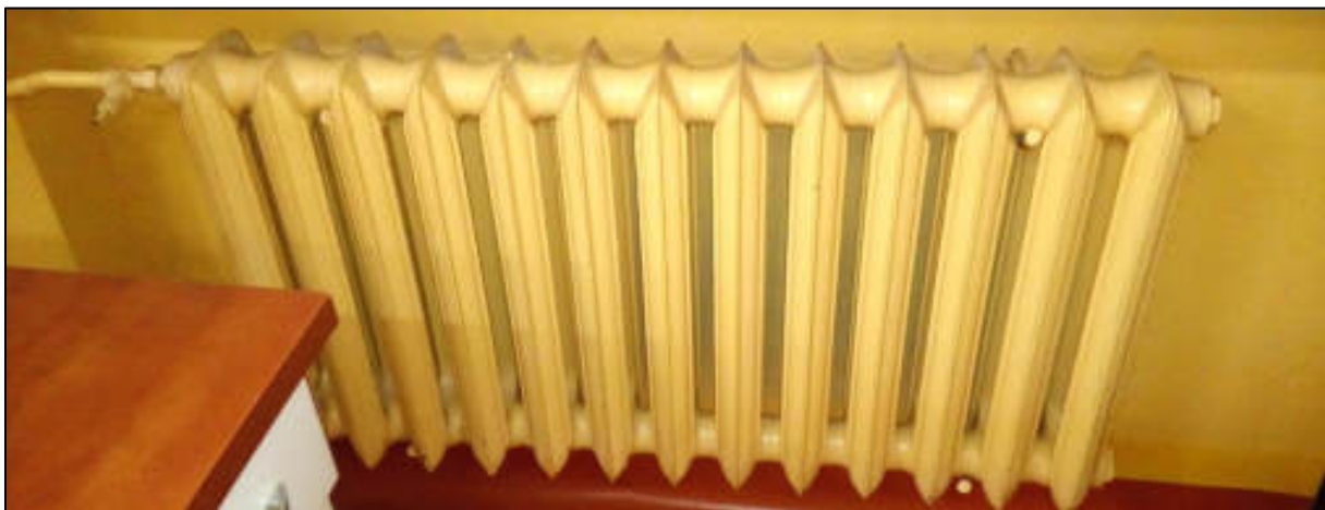
Abb. 124: Zentral gesteuerter Heizkörper ohne eigenes Thermostatventil in einer begangenen Liegenschaft
