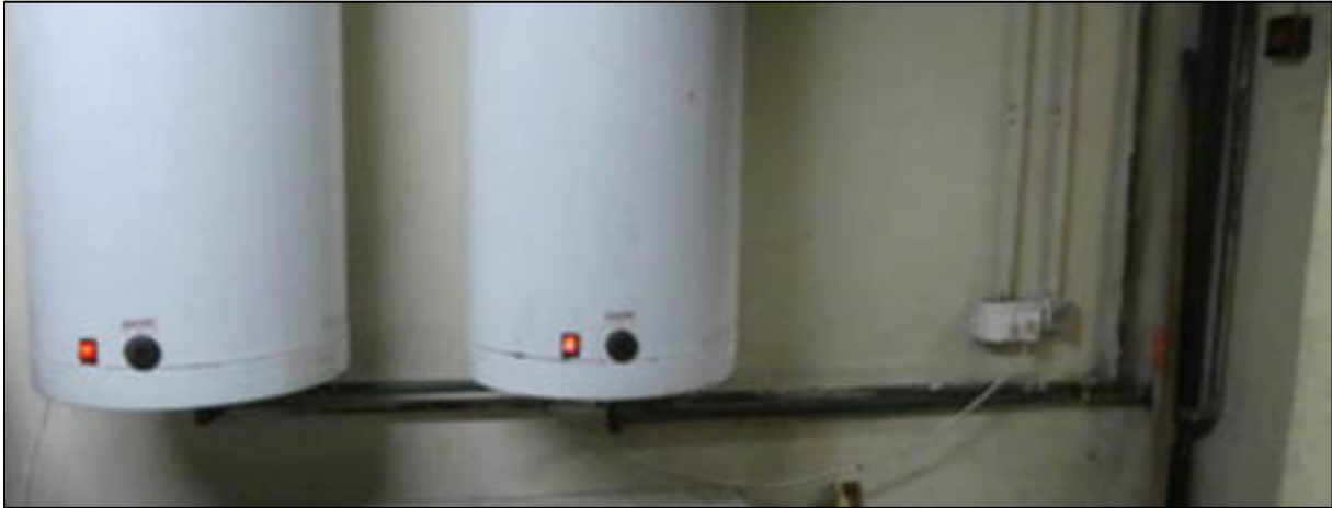
Abb. 113: Zentrale Warmwasserbereitung mit unisolierten Leitungen im Kulturhaus Hajnówka
