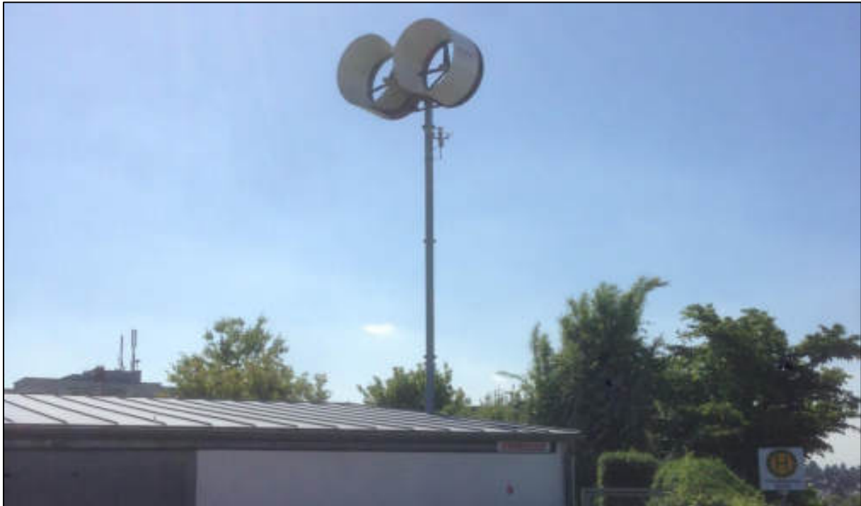
Abb. 85: Kleinstwindkraftanlage an einem Wohngebäude
