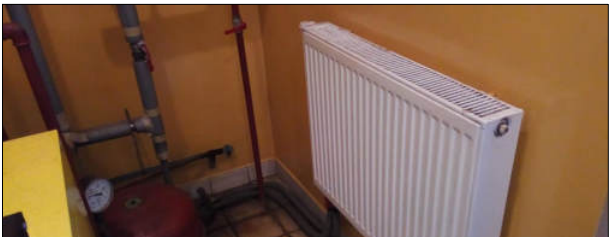
Abb. 123: Heizkörper in einem Raum ohne Heizenergiebedarf
