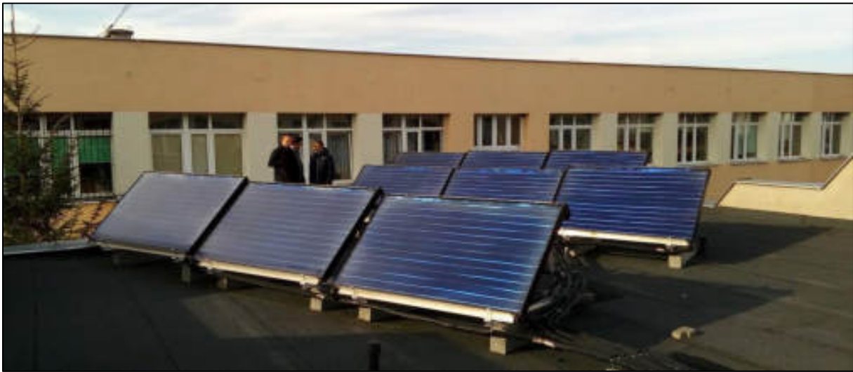
Abb. 74: Solarthermieanlage auf dem Dach einer Schule in Hajnówka
