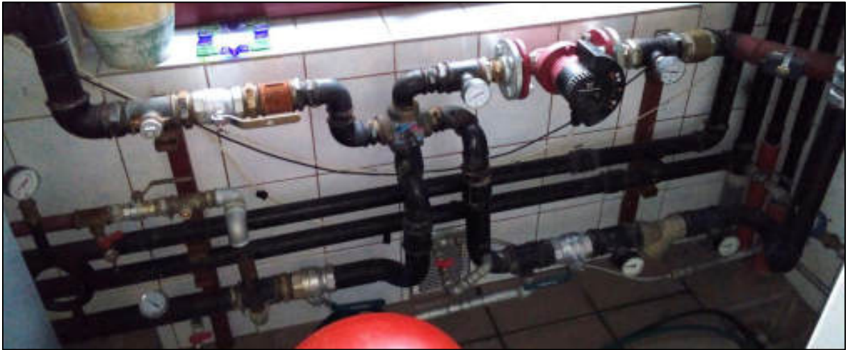
Abb. 122: Ungedämmte Heizungsleitungen im Heizraum in einer untersuchten Liegenschaft
