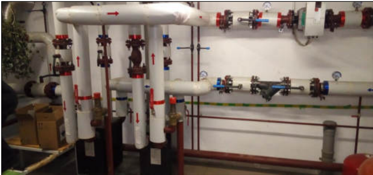
Abb. 107: Die Wärmetauscher im Anschlussraum des Spaßbads von Hajnówka
