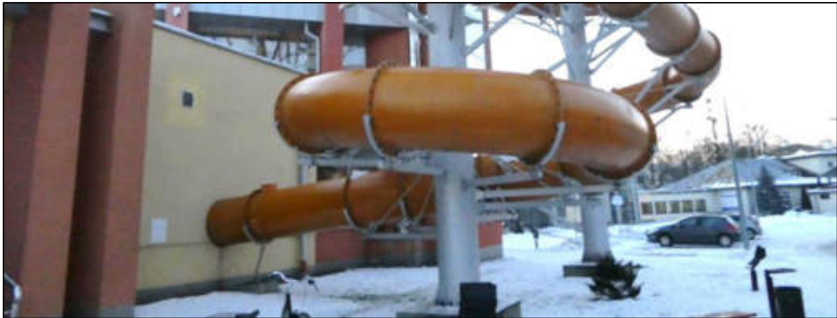
Abb. 108: Die ungedämmte Wasserrutsche des Spaßbads in Hajnówka
