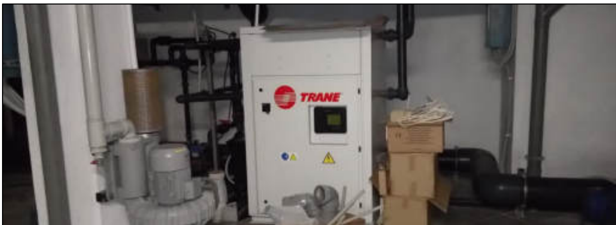
Abb. 106: Die Wärmepumpe zur Energierückgewinnung im Spaßbad von Hajnówka
