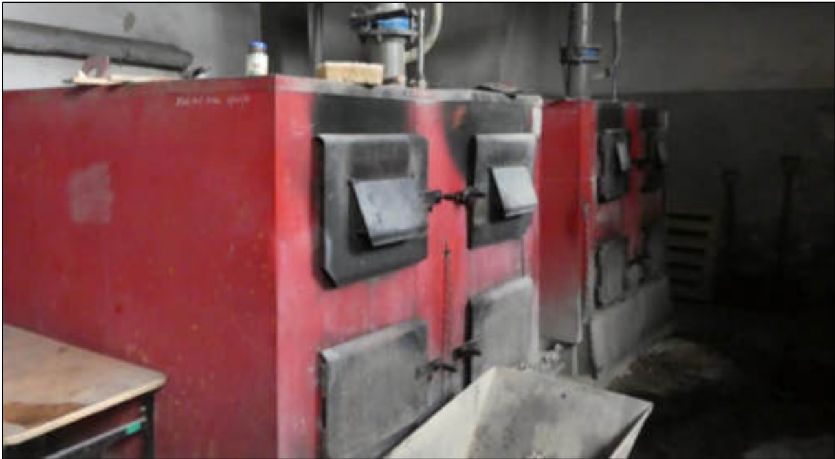
Abb. 115: Kohlebefeuerter Heizkessel im Schulgebäude der Grundschule in Hajnówka
