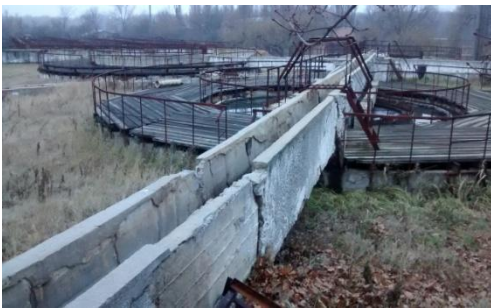
Stark sanierungsbedürftige Kläranlage in Ungheni, Republik Moldau
