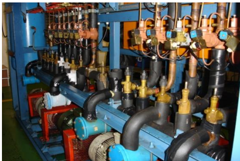
Kälteanlage eines Supermarktes
