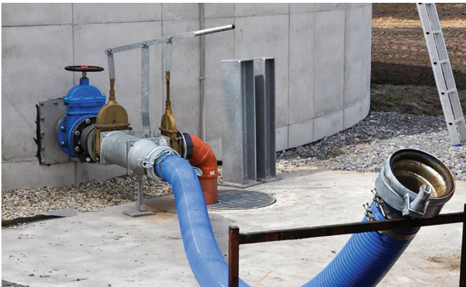
Fig. 8: Stație de evacuare a gunoiului de grajd lichid cu groapă adiacentă
