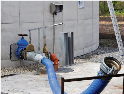
❶ Рис. 8: Станция отвода жидкого навоза с прилегающей ямой.
