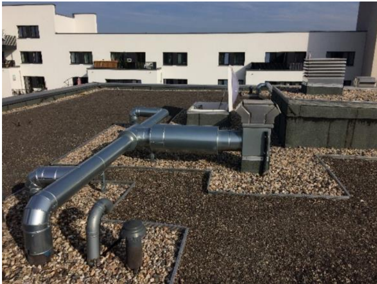
Abbildung 57: Dachaufbauten aus verzinkten Rohren in Testgebiet B
