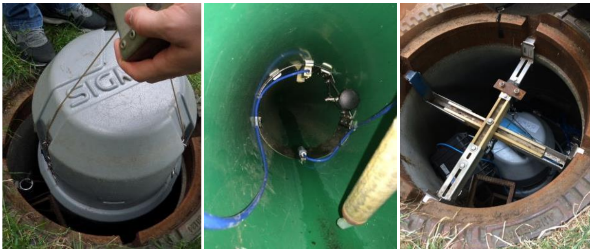
Abbildung 9: Installation von Probennehmer und Durchflussmessung im Testgebiet A
