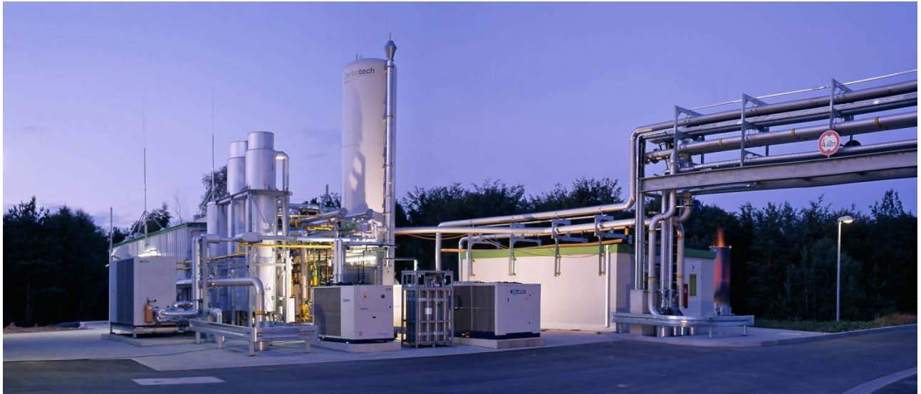
Abbildung 67: Gasaufbereitung und Einspeisung
