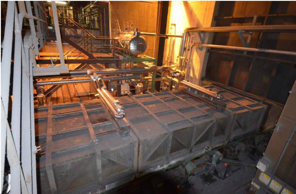
Abbildung 14: Pilotanlage zur Nutzung der Strahlungswärme von Brammen
