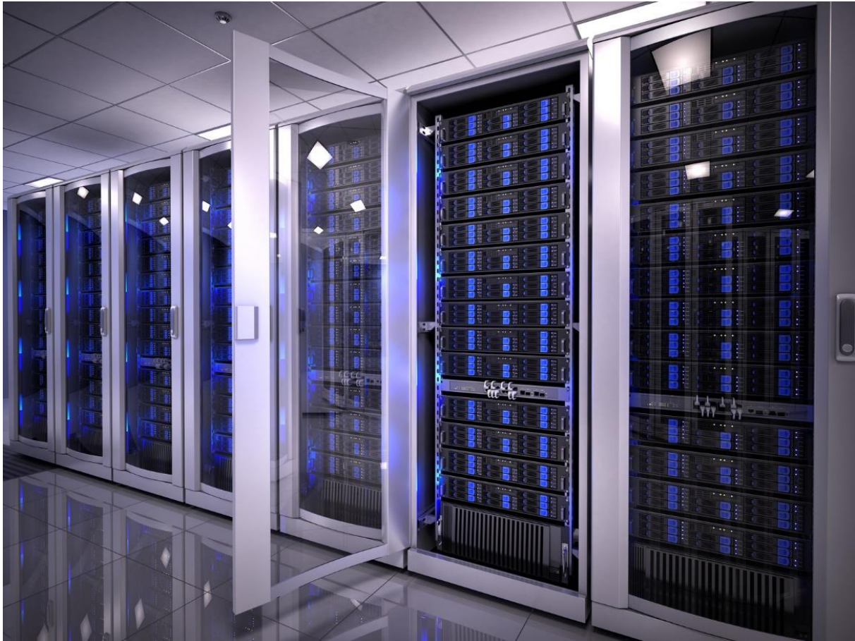
Abbildung 26: Server in einem Rechenzentrum
