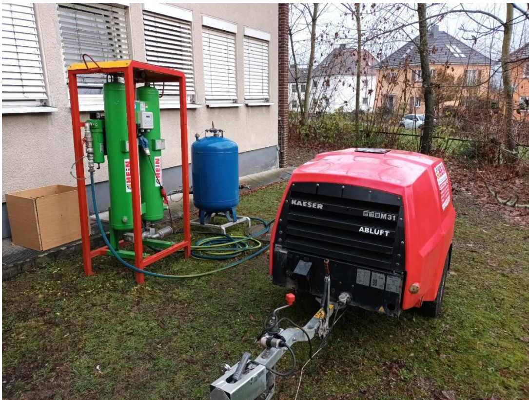
Abbildung 17: Kompressor für die Sicherstellung der Druckluftversorgung im Ringversuch
