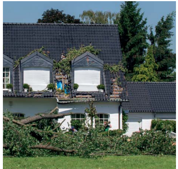
Stürme und Hagel können große Schäden an Gebäuden anrichten. (Foto: Dieter Hopf / pixelio.de)
