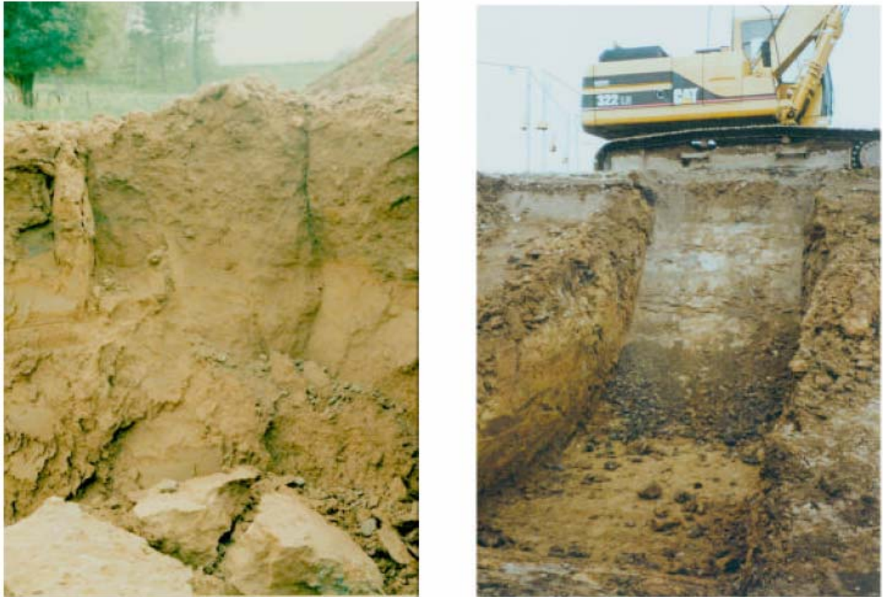
Abbildung 9.6.3.2.1: Risse als Folge größerer bergbaulich bedingter Zerrungen (links) und ihre Beseitigung durch Aufgrabung und Wiederbefüllung (rechts).
